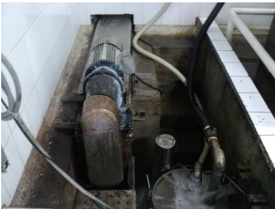
Foto 3. Bombas de agua para el sistema de enfriamiento de cascada.
