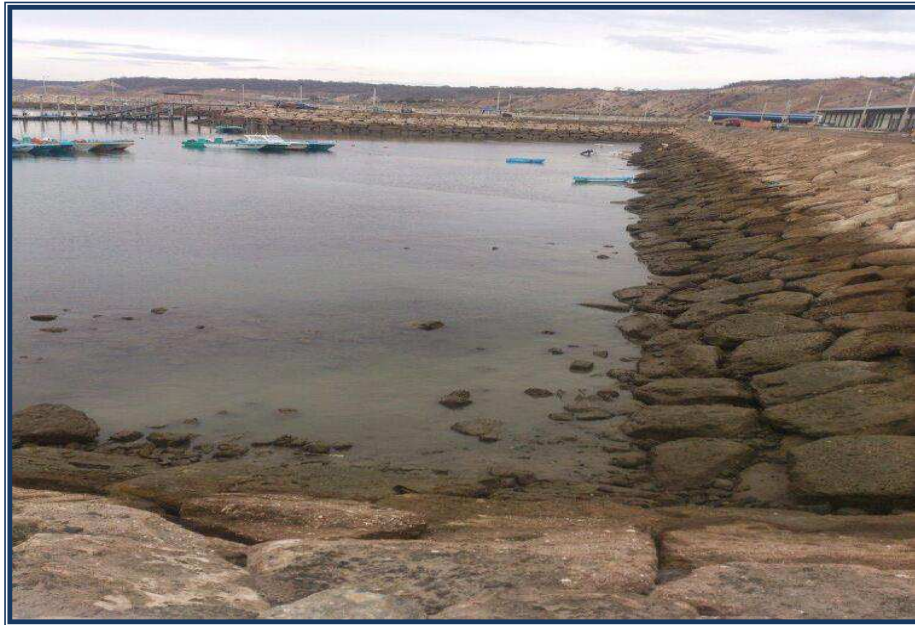
Figura 29. Sedimentación interna esquina plataforma
