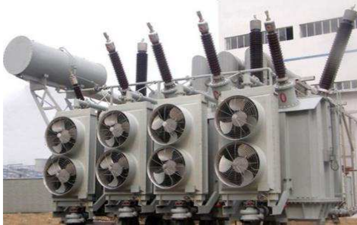
Figura 18. Refrigeración de los transformadores de potencia
