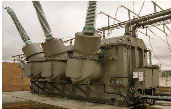
Figura 17. Tanques del transformador de potencia
