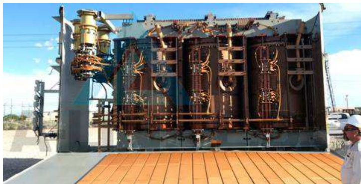
Figura 16. Núcleo del transformador de potencia
