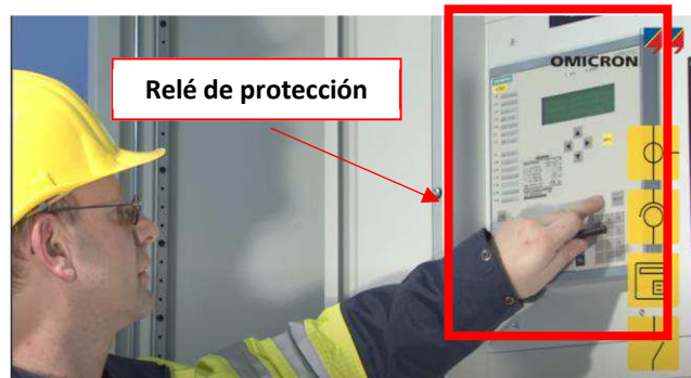
Figura 24. Relé de protección en una subestación eléctrica
