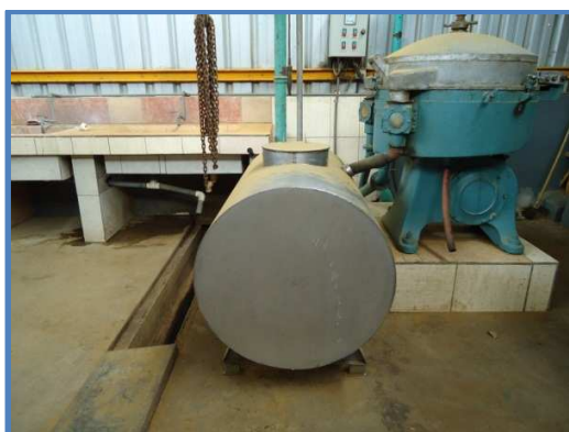
FIGURA N°25. CENTRIFUGA Y TANQUE DE ALMACENAMIENTO DE ACEITE.
