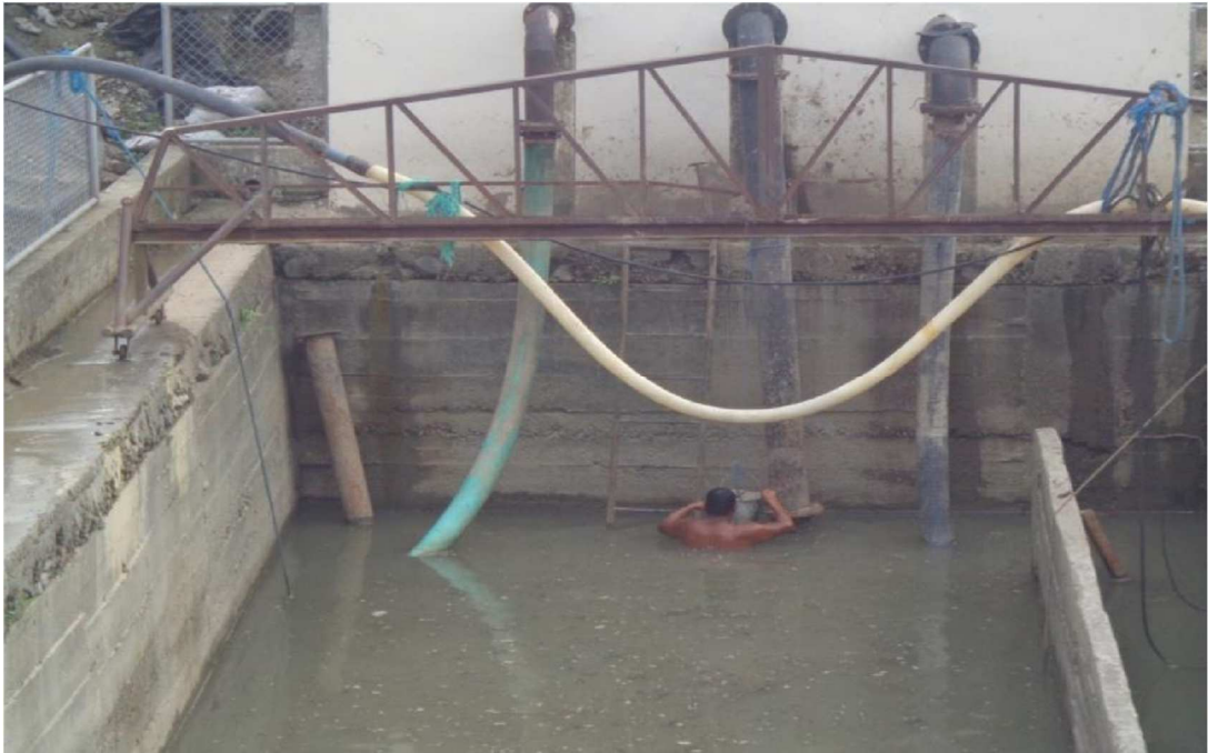
GRAFICO 5.3 DESARENADOR-ESTACIÓN DE BOMBEO-CAPTACIÓN. Originales del lugar de estudio
