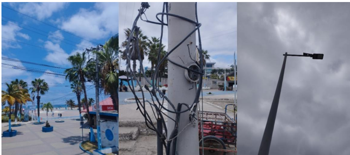
Ilustración 9 Diferentes problemáticas del sistema de iluminación del Malecón escénico de la playa el Murciélago
