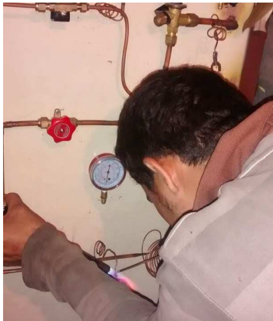
Figura 30: Corrección de soldadura en junta soldable que presentó fuga Elaborado por: Fernando Delgado Mero – Humberto Loo Palma
