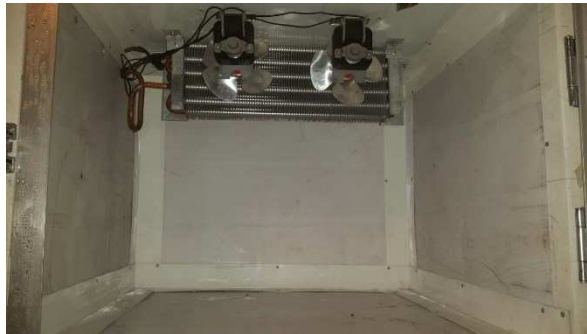
Figura 16: Ubicación de evaporador dentro de cámara de congelación Elaborado por: Fernando Delgado Mero – Humberto Loor Palma
