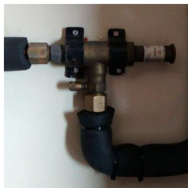
Figura 23: Montaje de regulador de presión de evaporación Elaborado por: Fernando Delgado Mero – Humberto Loo Palma
