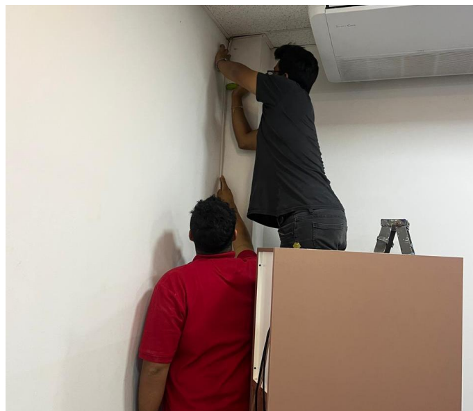
Ilustración 62. Instalación de puntos en el sistema de control del auditorio.
