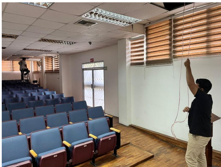
Ilustración 57. Conexión de cables de audio.
