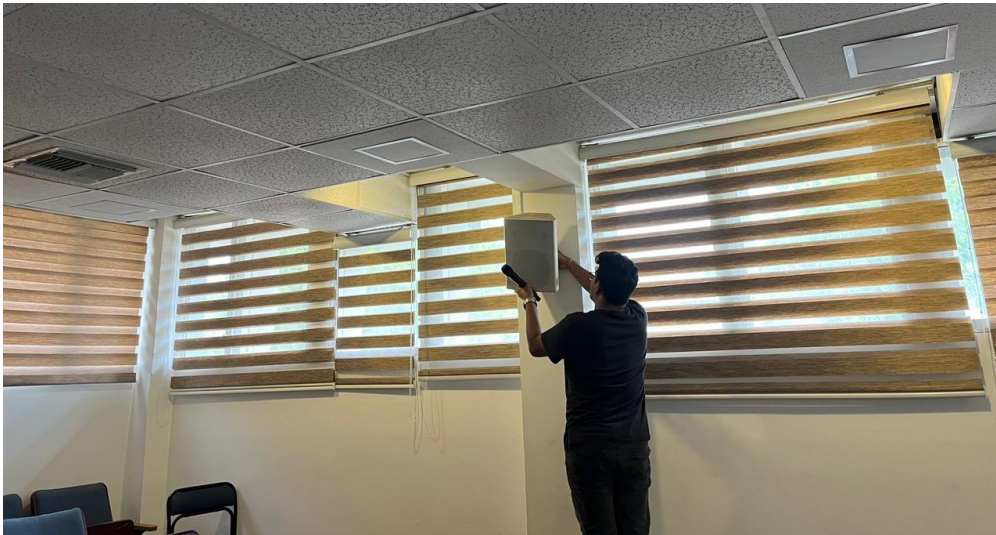
Ilustración 34. Fijación mecánica y orientación de parlantes
