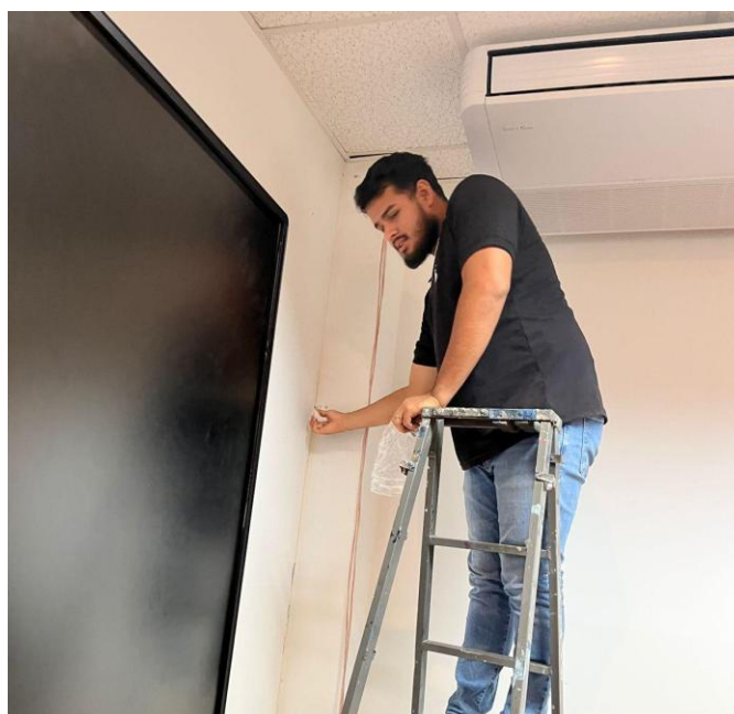
Ilustración 60. Enrutamiento vertical del cableado de señal.
