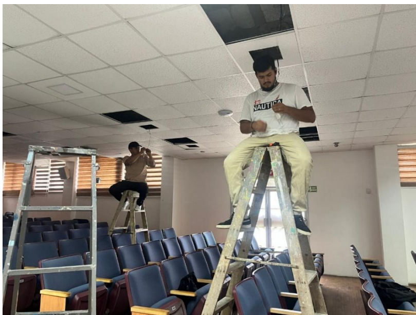
Ilustración 59. Montaje y cableado de los componentes del sistema.
