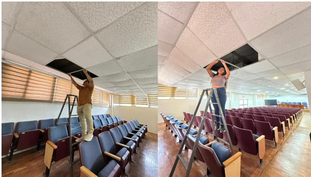
Ilustración 34: Preparación del auditorio para las nuevas iluminarias.
