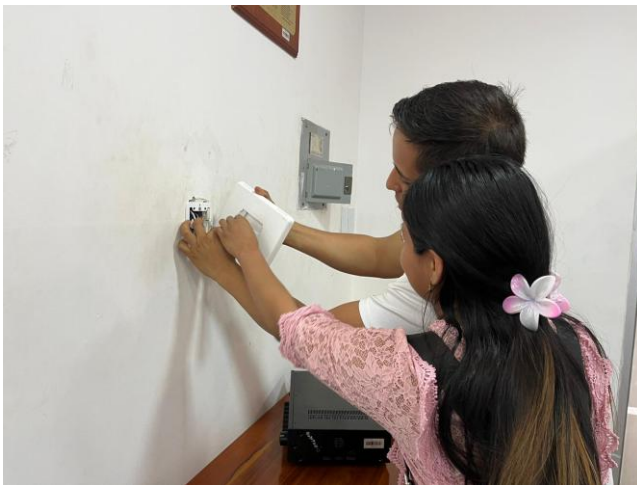
Ilustración 26: Instalación del Hub central
