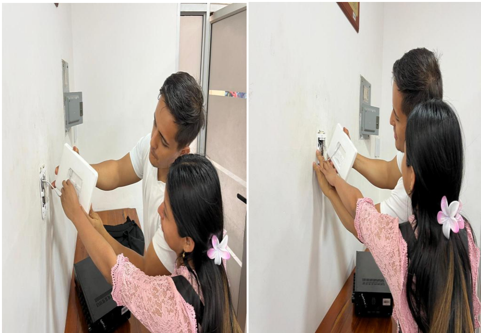
Ilustración 38: Instalación del panel hub Alexa.
