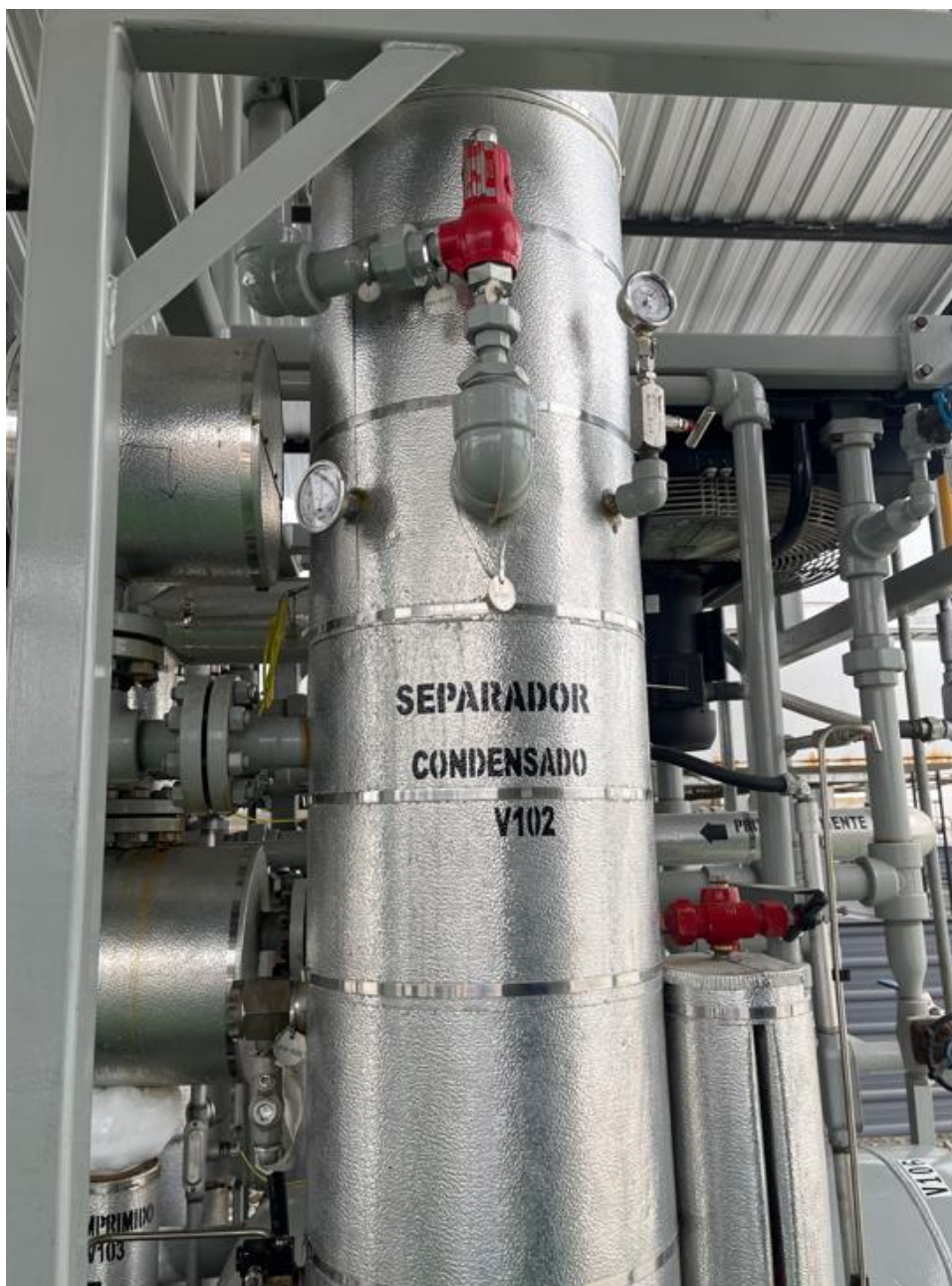
Ilustración 4 A1 Separador de condensado.
