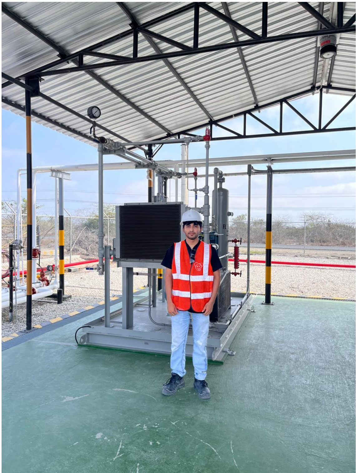
Ilustración 12 A9 Visita técnica – Skid de compresión
