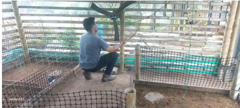
Anexo 3. Instalación y verificación del sistema de ventilación para el control ambiental del galpón.
