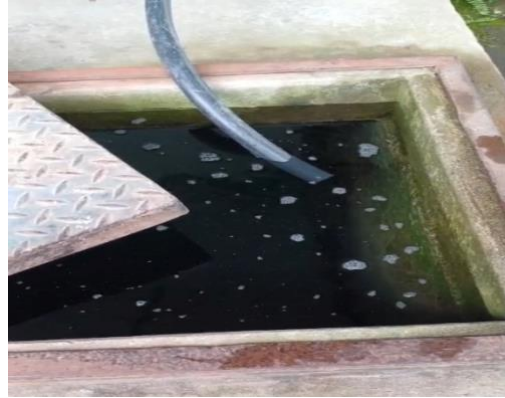
Anexo 9. Prueba de funcionamiento del sistema. 1
