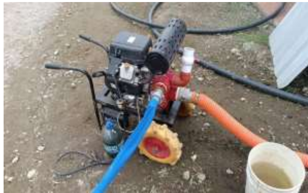
Figura 5. Bomba centrífuga de 4 HP utilizada para el suministro de agua del sistema de riego.
