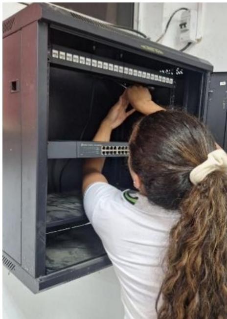
Ilustración 15 Implementación de Patch Panel
