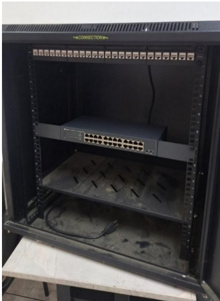
Ilustración 13 Implementación de Rack
