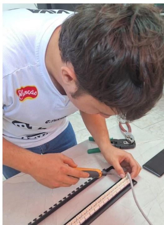
Ponchado al Patch Panel a los cables UTP
