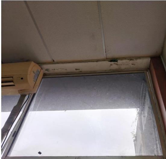
Figura 10 Filtraciones de Agua
