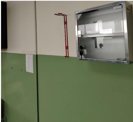
Figura 4 No cuentan con extintores
