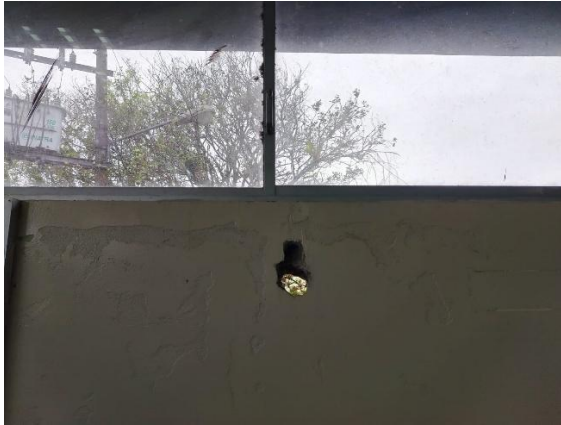
Figura 6 Paredes en mal estado
