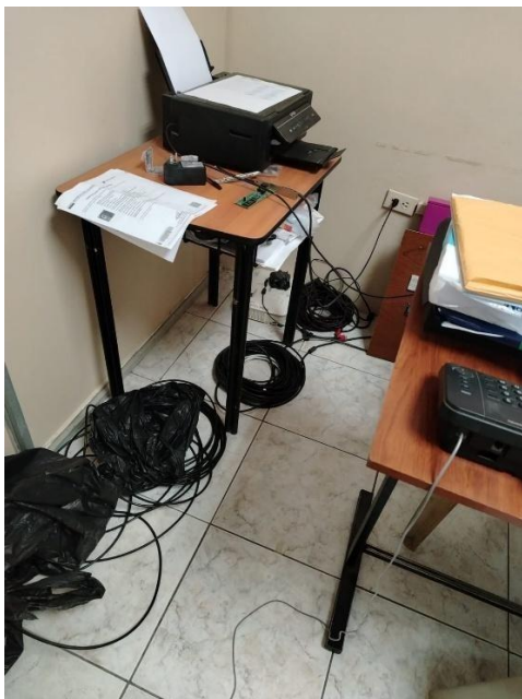
Figura 8 Obstrucción de cables
