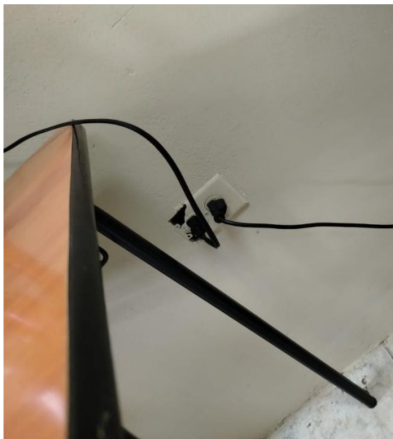
Figura 9 Enchufes en mal estado
