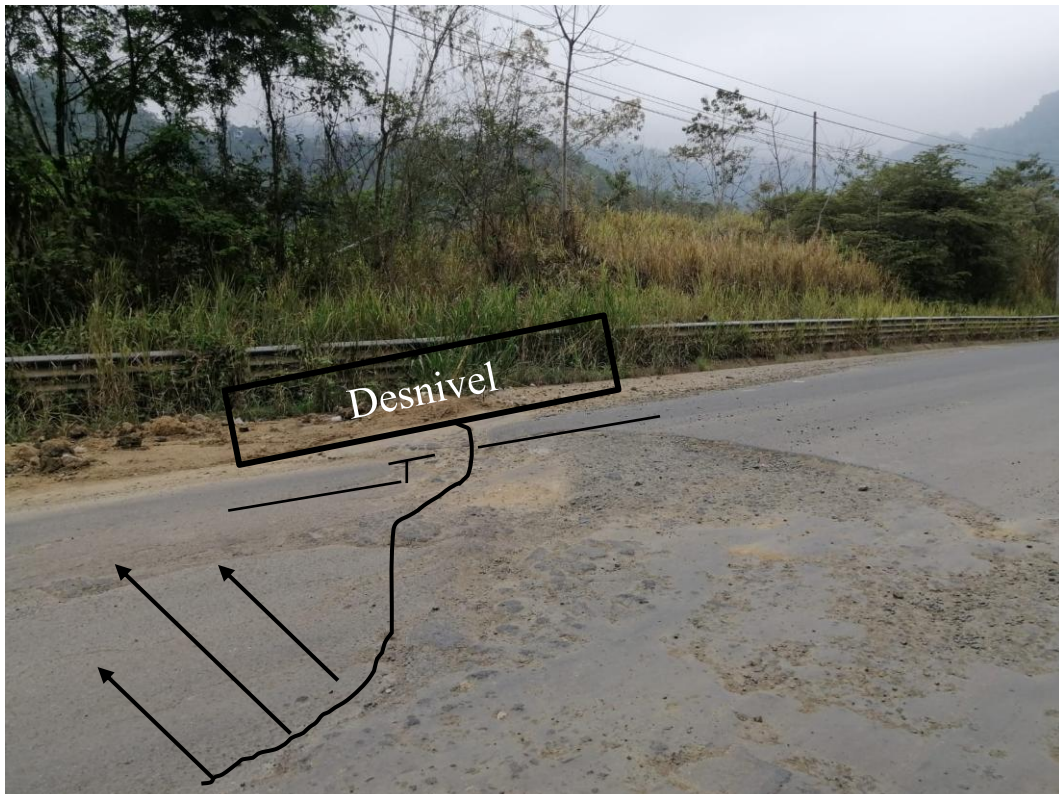
Figura 18. Desplazamiento del eje de la vía hacia el talud
