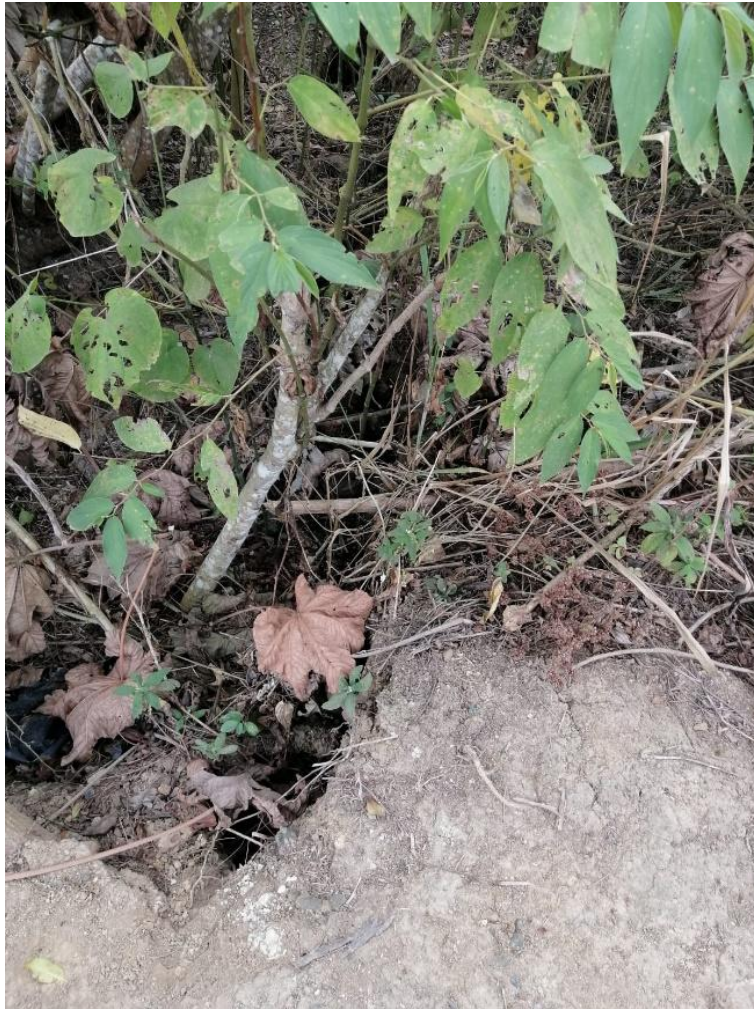
Figura 38. Erosión del suelo del talud de la vía Nota. Elaboración propia
