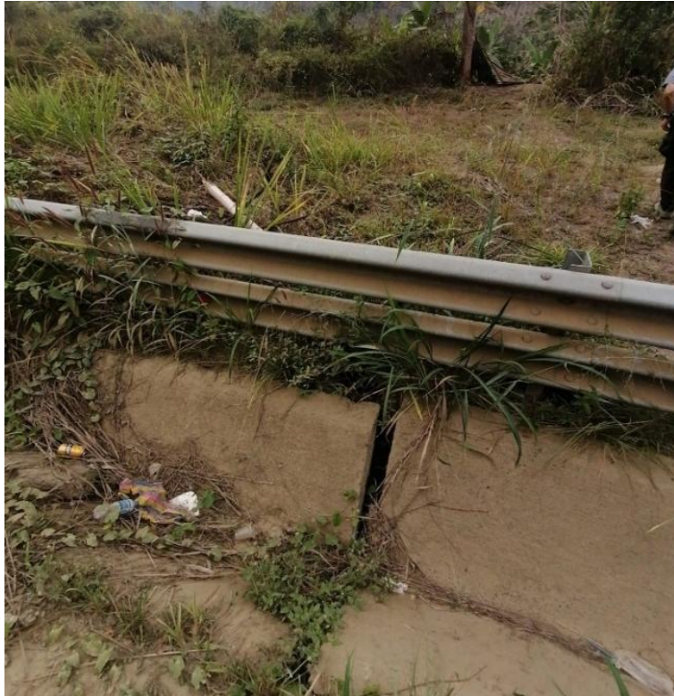
Figura 16. Junta de cuneta separada (2025)
