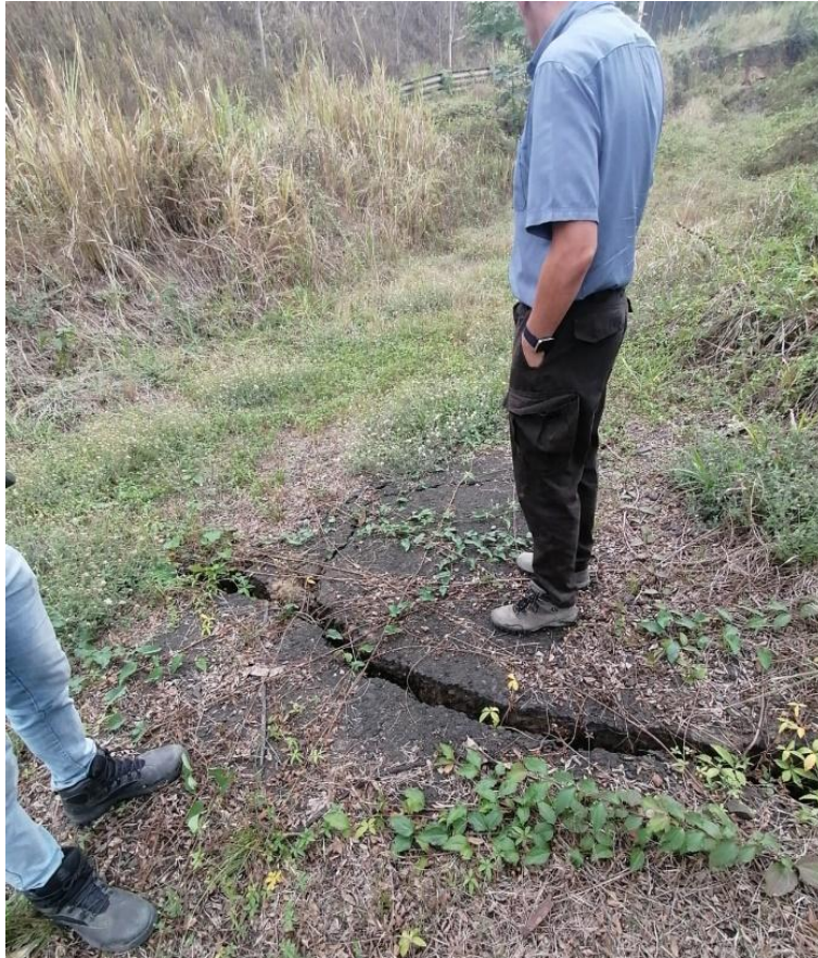
Figura 22. Grietas en el talud de la vía
