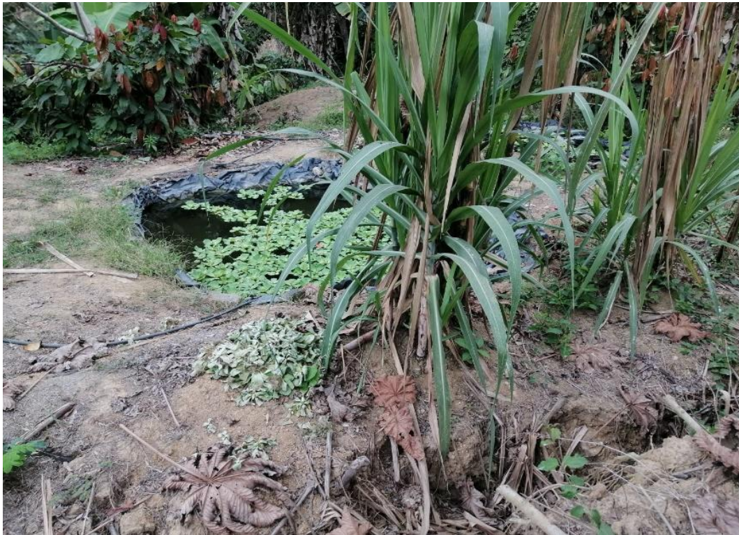
Figura 41. Presencia de piscinas de peces en el talud de la vía
