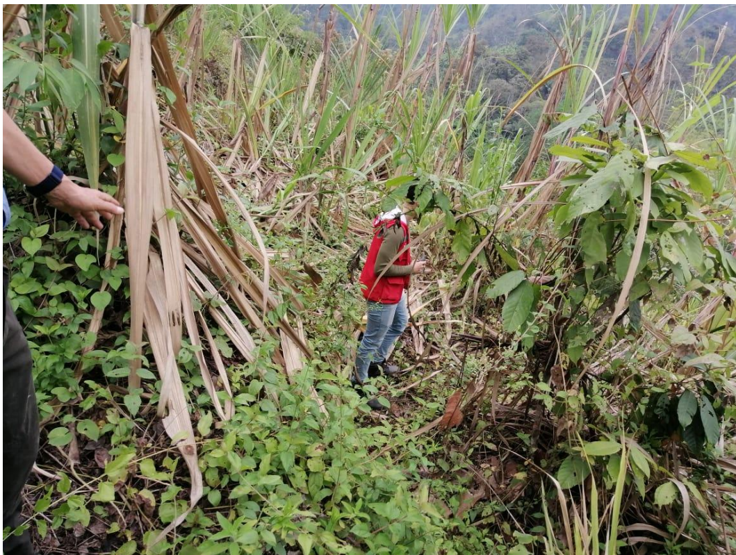
Figura 40. Talud con desnivel - presencia de asentamiento
