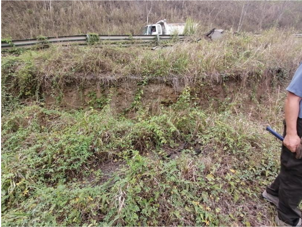
Figura 25. Asentamiento del talud y pérdida de material
