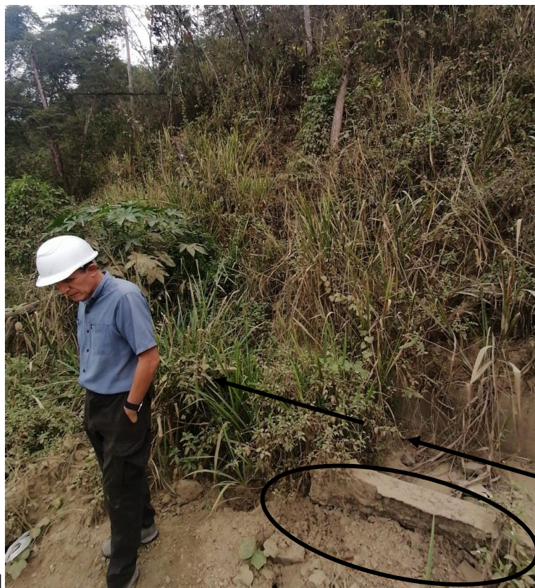
Figura 17. Drenaje lateral de la vía, fíjese el bordillo desplazado
