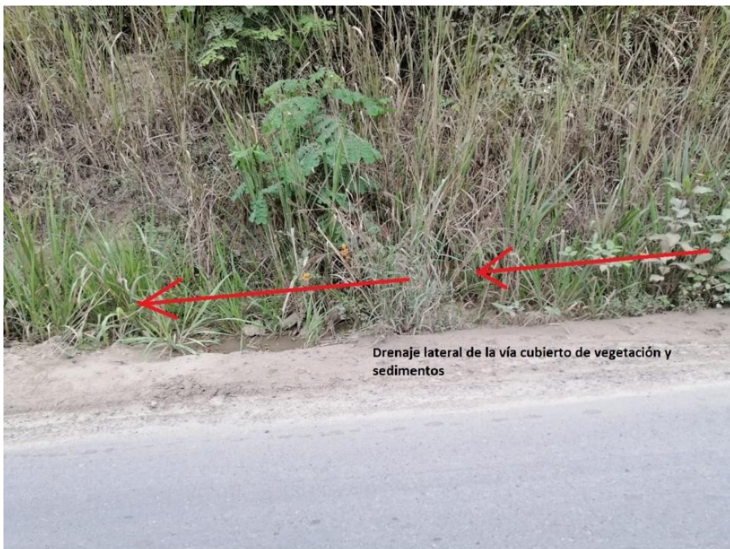
Figura 15. Cunetas, drenaje lateral de la vía cubierto de vegetación (2025)
