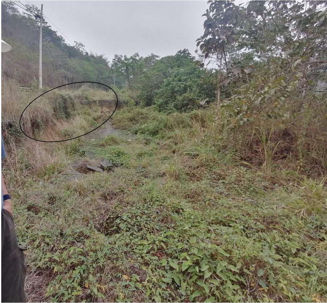
Figura 24. Inestabilidad del talud de la vía (2025)
