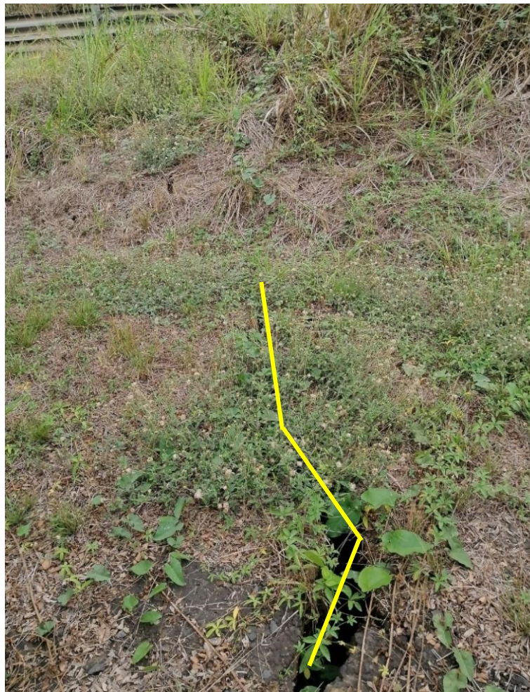
Figura 21. Grietas en el talud de la vía
