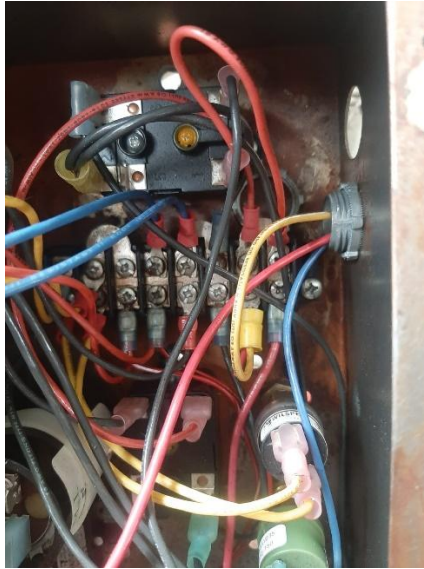
Conexión eléctrica. Elaborada por el autor.
