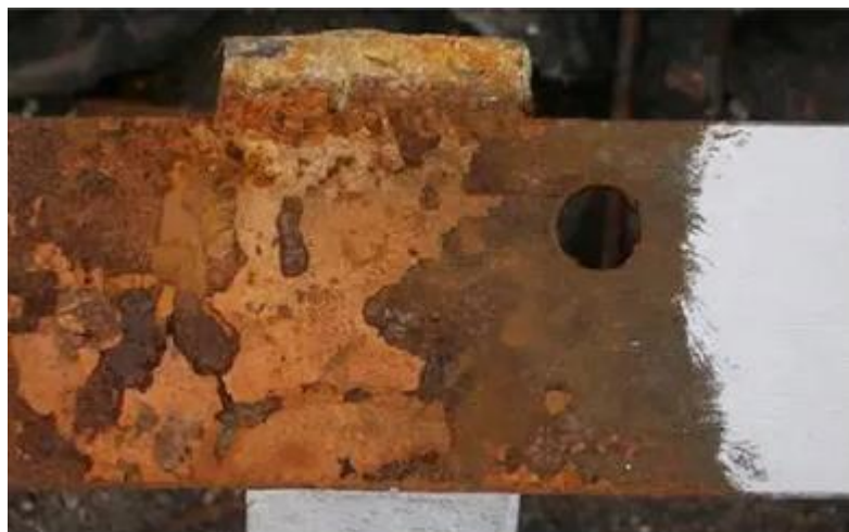
Figura 1: Corrosión Generalizada (Zavaleta, 2019)
