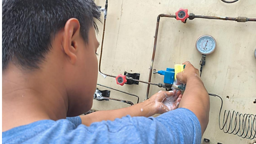
Anexo 5.1: Limpieza superficial de todo el equipo y detección de fugas.
