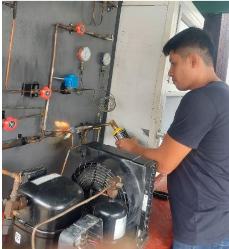
Anexo 5.5: Soldadura a fugas presentadas
