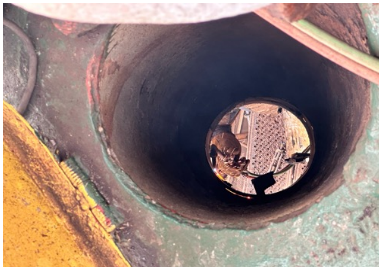
Ilustración 20: Ductos de los escobenes.
