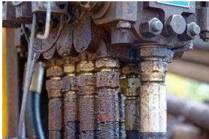
Ilustración 7 Fuga de fluido hidráulico en equipos industriales
