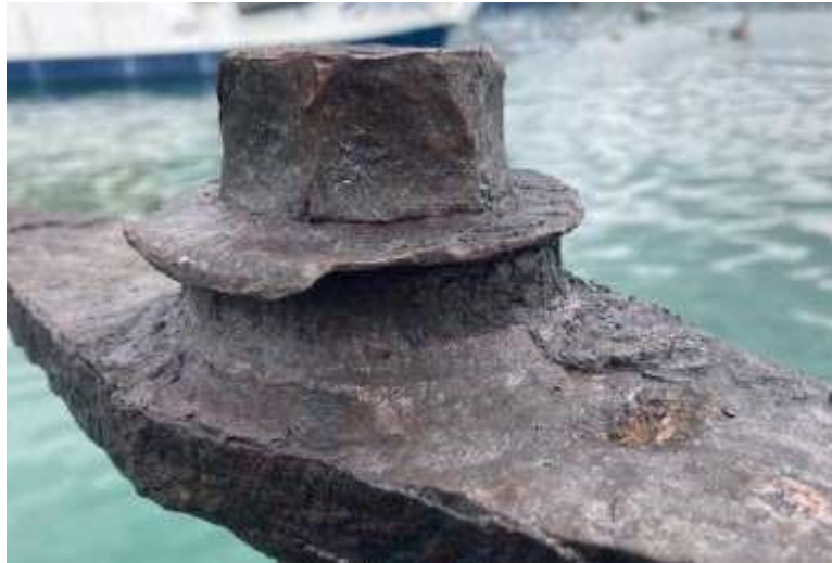
Ilustración 38 Tuerca del abanico deteriorada
