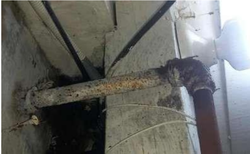
Ilustración 28 Accesorios con gran daño corrosivo
