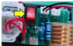
Ilustración 10. Botón de encendido del sistema eléctrico
