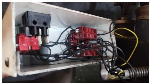
Imagen 11: Sistema eléctrico de arranque
