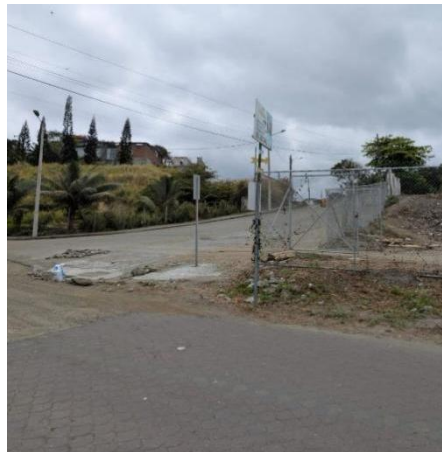
Ilustración 7 Vías deterioradas en la calle del malecón, imagen elaborada por el tesista
