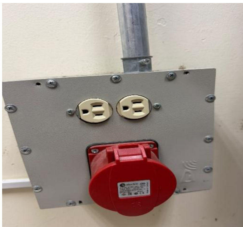
Figura 2 Tomacorriente 110V del laboratorio de Potencia.
