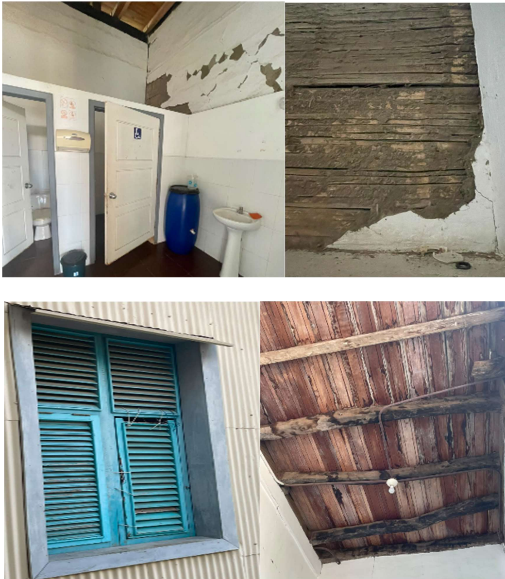
Figura 6. Identificación de las áreas con mayor deterioro
