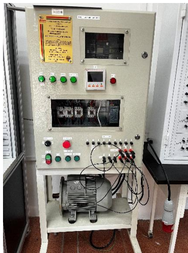
Figura 19: Taller de electricidad de la facultad de Ingeniería Marítima Fuente: Propia
