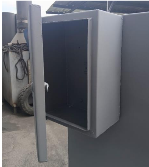
Figura 37. Caja eléctrica. Fuente: Gavilánez y Villafuerte (2025)
