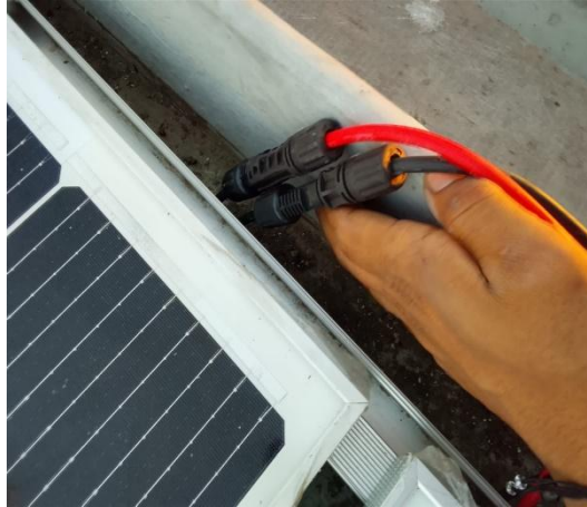
Figura 20: Conexión de los paneles solares con cables AWG 10 y conectores MC4
