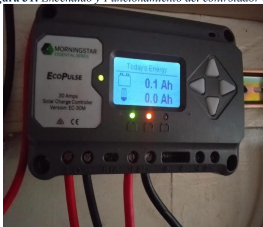
Figura 31: Encendido y Funcionamiento del controlador de carga
