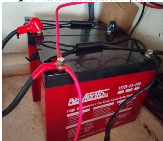
Figura 24: Conexión de las baterías en paralelo
