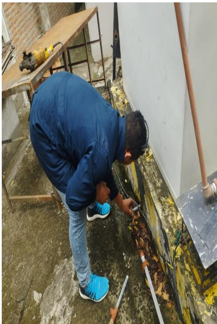
Verificación de posible fugas de agua de la cisterna interna de la torre. Fuente: Elaborado por los Autores
