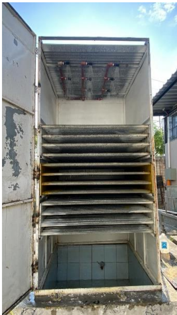
Prueba de funcionamiento de los rociadores (chispeadores). Fuente: Elaborado por los autores.
