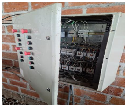
Figura. 14 Análisis de un tablero de fuerza para la identificación de los dispositivos de protección y maniobra.
