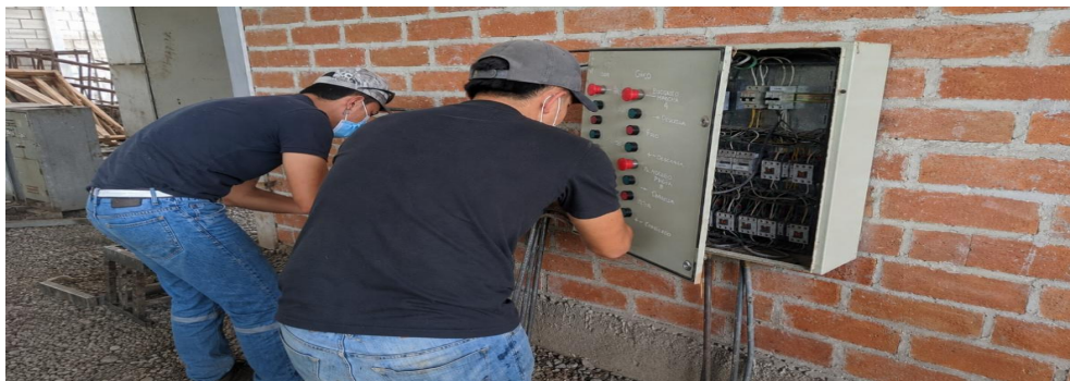
Figura. 13 Inspección de un tablero de control para la identificación de dispositivos eléctricos.
