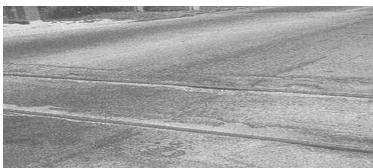
Figura 1.41. Tipo de Falla Cruce de vía férrea – Nivel de severidad Medio.
