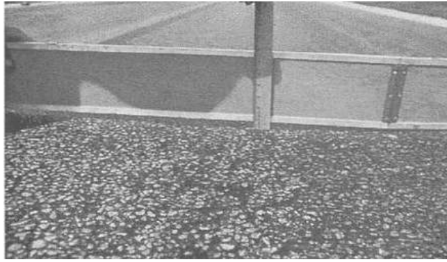
Figura 1.44. Tipo de Falla de ahuellamiento – Nivel de severidad medio. Tomado de PAVEMENT MANAGEMENT FOR AIRPORTS ROADS AND PARKING LOTS- (Segunda ed.), por Shahin, 2005.
