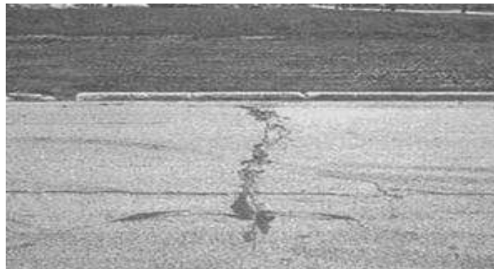
Figura 1.32. Tipo de Falla Fisuras longitudinales y transversales – Nivel de severidad Alto. Tomado de PAVEMENT MANAGEMENT FOR AIRPORTS ROADS AND PARKING LOTS- (Segunda ed.), por Shahin, 2005.
