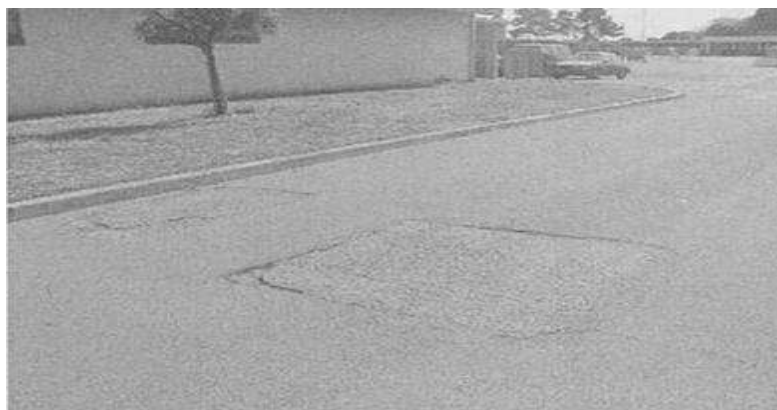
Figura 1.35. Tipo de Falla Parches y parches de cortes utilitarios – Nivel de severidad Alto. Tomado de PAVEMENT MANAGEMENT FOR AIRPORTS ROADS AND PARKING LOTS- (Segunda ed.), por Shahin, 2005.
