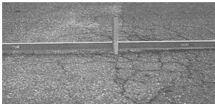
Figura 1.19. Tipo de Falla Depresión – Nivel de severidad Medio.
