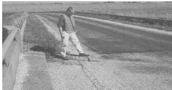
Figura 1.47. Tipo de Falla Desplazamientos – Nivel de severidad medio. Tomado de PAVEMENT MANAGEMENT FOR AIRPORTS ROADS AND PARKING LOTS- (Segunda ed.), por Shahin, 2005.
