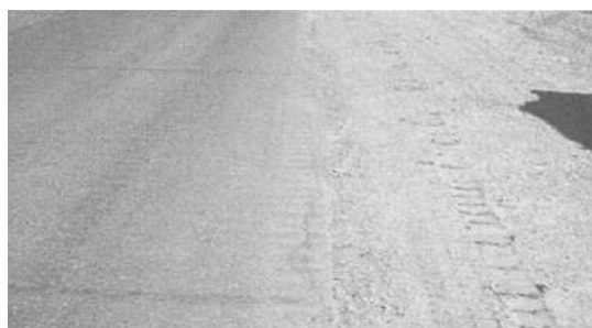
Figura 1.24. Tipo de Falla Fisura de reflexión de junta – Nivel de severidad Bajo.
