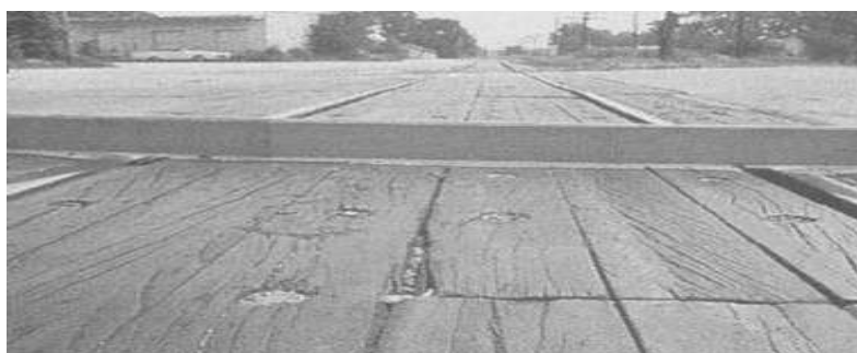
Figura 1.40. Tipo de Falla Cruce de vía férrea – Nivel de severidad Bajo.
