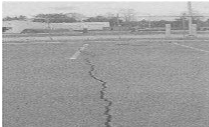
Figura 1.31. Tipo de Falla Fisuras longitudinales y transversales – Nivel de severidad Medio. Tomado de PAVEMENT MANAGEMENT FOR AIRPORTS ROADS AND PARKING LOTS- (Segunda ed.), por Shahin, 2005.
