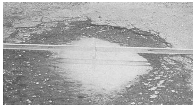
Figura 1.39. Tipo de Falla Hueco - Baches nivel alto
