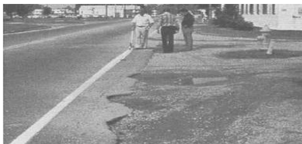
Figura 1.23. Tipo de Falla Fisura de borde – Nivel de severidad Alto.
