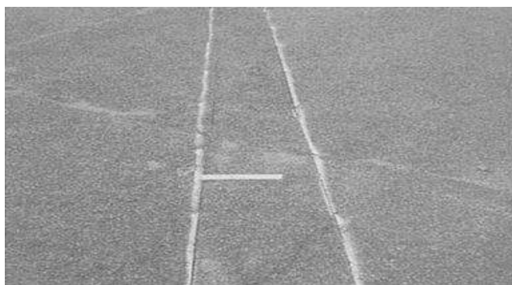
Figura 1.34. Tipo de Falla Parches y parches de cortes utilitarios – Nivel de severidad Medio.
