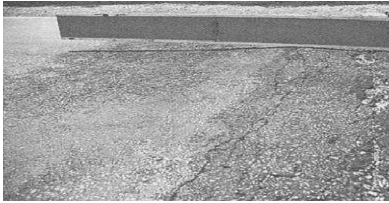
Figura 1.14. Tipo de Falla Abultamiento y Hundimientos – Nivel de severidad Alto. Tomado de PAVEMENT MANAGEMENT FOR AIRPORTS ROADS AND PARKING LOTS- (Segunda ed.), por Shahin, 2005.
