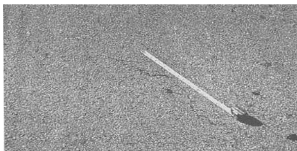
Figura 1.49. Tipo de Falla Fisura Parabólica – Nivel de severidad bajo.
