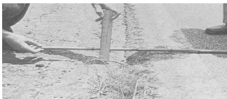
Figura 1.28. Tipo de Falla Desnivel carril-berma – Nivel de severidad Medio.
