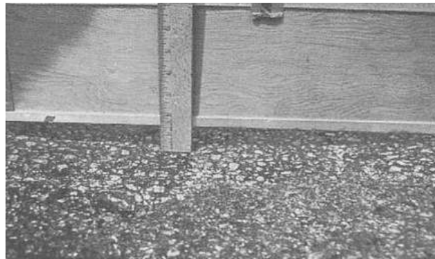
Figura 1.45. Tipo de Falla ahuellamiento – Nivel de severidad alto. Tomado de PAVEMENT MANAGEMENT FOR AIRPORTS ROADS AND PARKING LOTS- (Segunda ed.), por Shahin, 2005.
