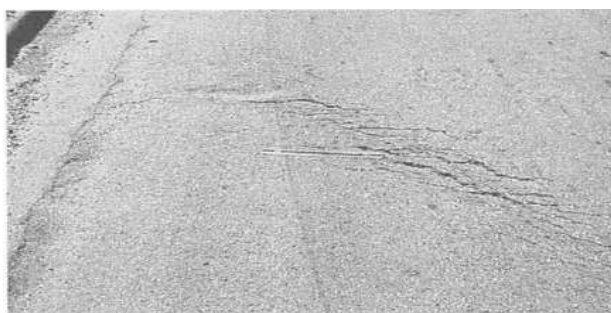
Figura 1.50. Tipo de Falla Fisura Parabólica – Nivel de severidad medio.
