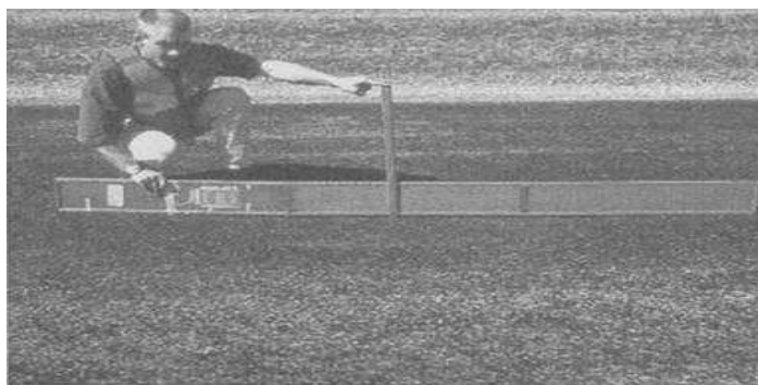
Figura 1.18. Tipo de Falla Depresión – Nivel de severidad Bajo.
