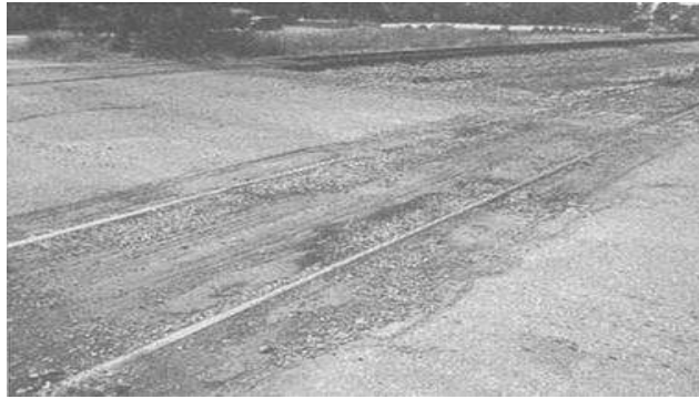
Figura 1.42. Tipo de Falla Cruce de vía férrea – Nivel de severidad Alto.
