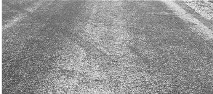
Figura 1.6. Tipo de Falla Exudación – Nivel de severidad Bajo.
