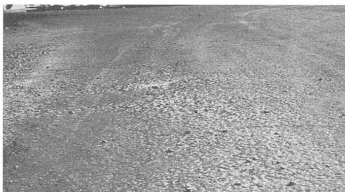
Figura 1.54. Tipo de Falla Desprendimientos de agregados/Meteorización y Erosión – Nivel de severidad medio.
