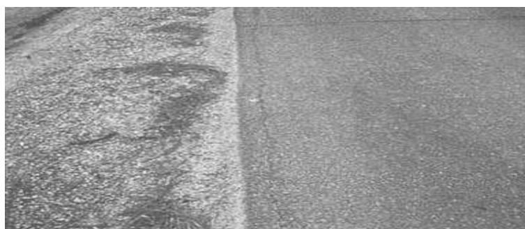
Figura 1.21. Tipo de Falla Fisura de borde – Nivel de severidad Bajo.
