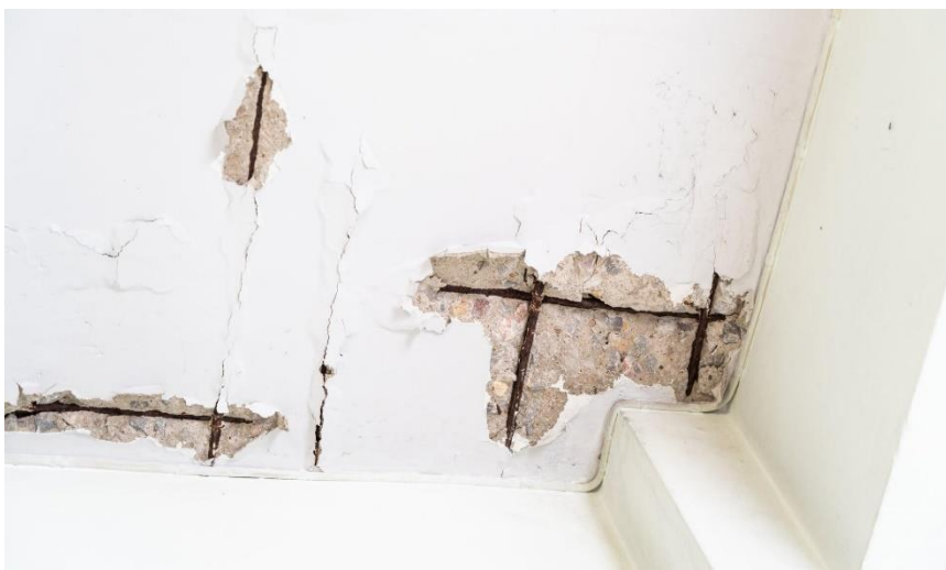
Ilustración 7 . Grietas estructurales internas ¿cómo detectarlas?
