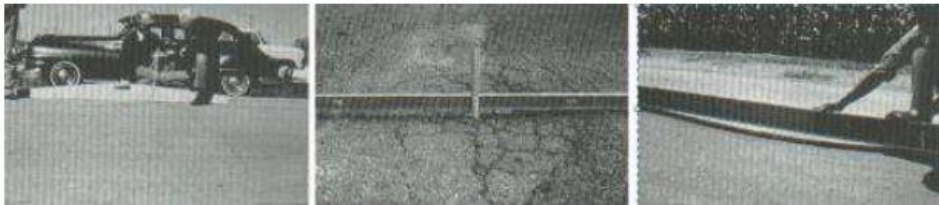
Figura 11: Falla por depresión de baja, media y alta severidad, de izquierda a derecha
