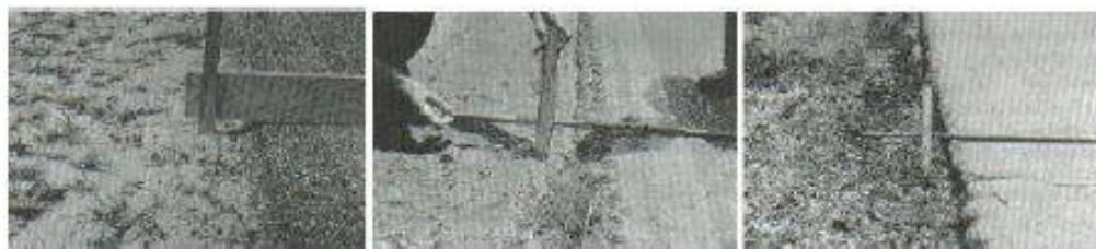
Figura 14: Falla por desnivel carril - berma de baja, media y alta severidad, de izquierda a derecha
