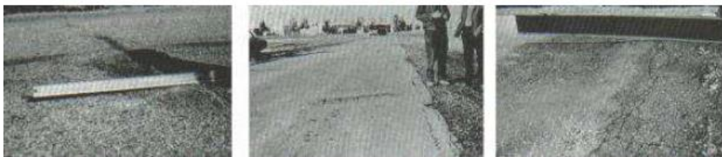
Figura 9: Falla por abultamientos y hundimientos de baja, media y alta severidad, de izquierda a derecha
