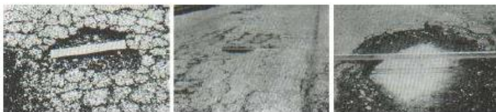
Figura 18: Falla por huecos de baja, media y alta severidad, de izquierda a derecha
