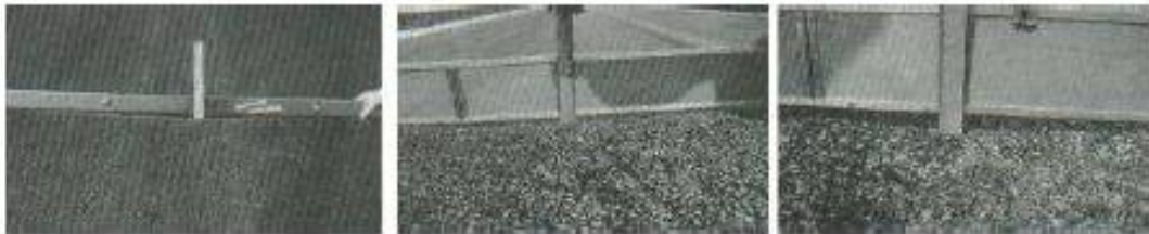
Figura 20: Falla por ahuellamiento de baja, media y alta severidad, de izquierda a derecha
