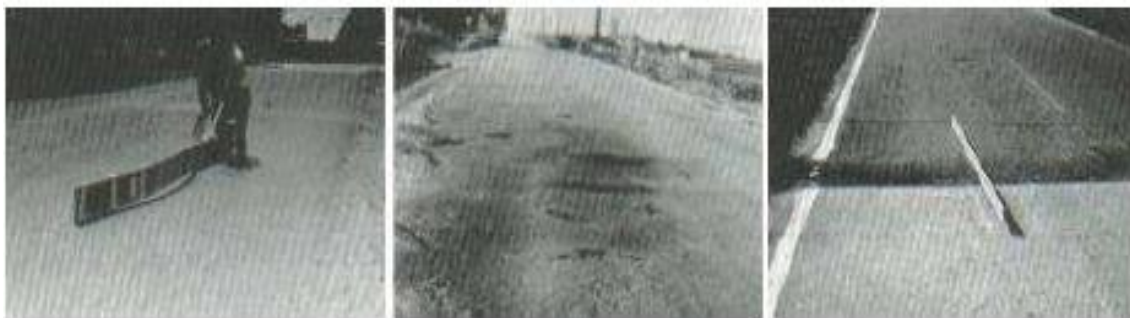
Figura 21: Falla por desplazamiento de baja, media y alta severidad, de izquierda a derecha
