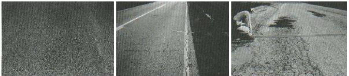
Figura 6: Falla de piel de cocodrilo de baja, media y alta severidad, de izquierda a derecha
