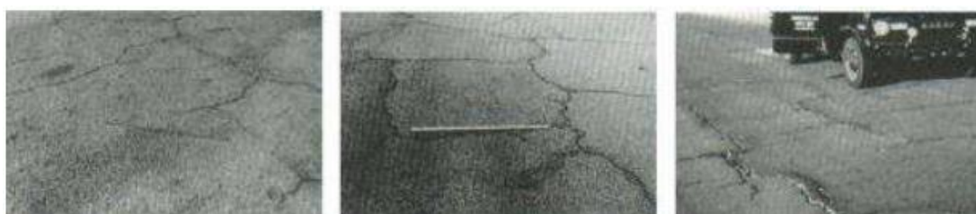
Figura 8: Falla por agrietamiento en bloque de baja, media y alta severidad, de izquierda a derecha
