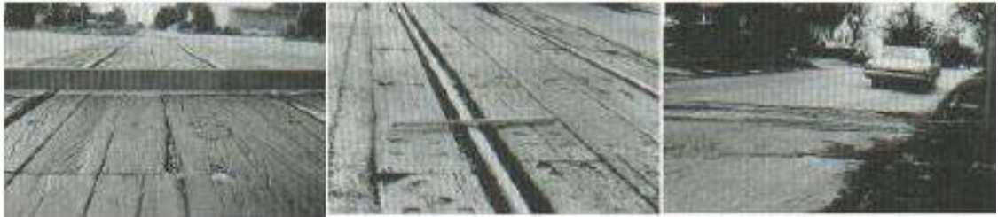
Figura 19: Falla en cruce de vía férrea de baja, media y alta severidad
