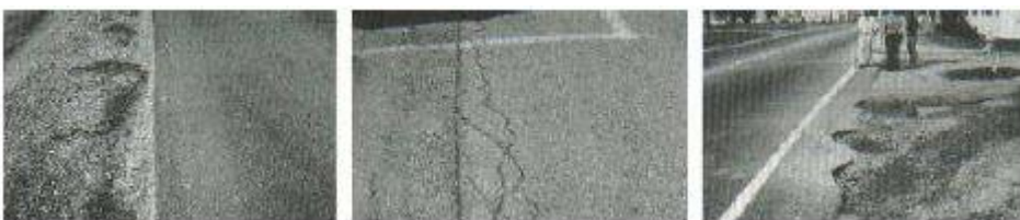
Figura 12: Falla por grietas de borde de baja, media y alta severidad, de izquierda a derecha
