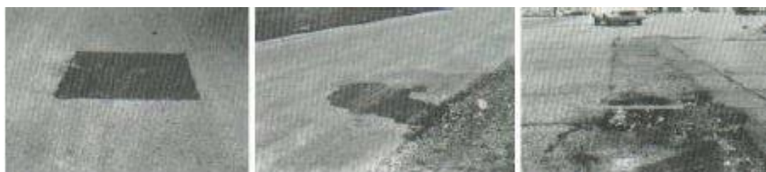
Figura 16: Parches y acometidas de baja, media y alta severidad, de izquierda a derecha
