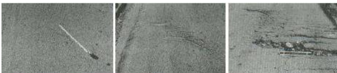
Figura 22: Falla por grietas parabólicas de baja, media y alta severidad, de izquierda a derecha
