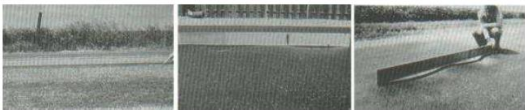
Figura 10: Falla por corrugación de baja, media y alta severidad, de izquierda a derecha
