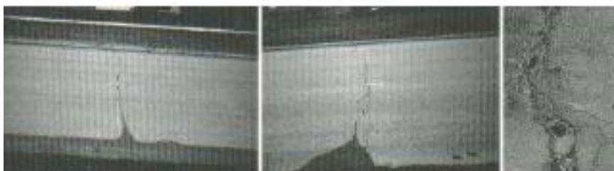
Figura 15: Grietas longitudinales / transversales de baja, media y alta severidad, de izquierda a derecha
