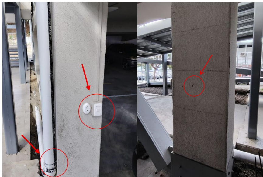
Ilustración 13 Elementos destructivos y agujero en la columna B1.
