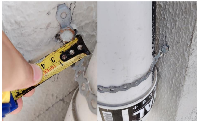
Ilustración 15 Agujero derecho con 2cm de diámetro e izquierdo de 1cm de diámetro de daño en la abrazadera de la columna B1.
