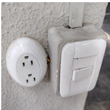
Ilustración 16 Tomacorriente e interruptor instalado en la columna B1.
