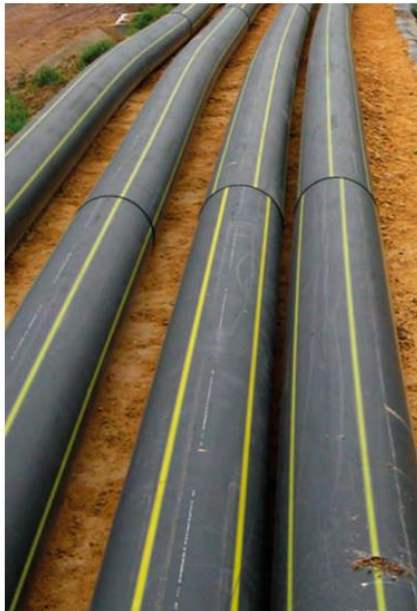
Ilustración 16 tubería de polietileno (RIVAL, s.f.)
