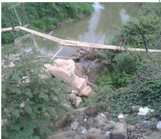
ZONA DE DESCARGAS CLANDESTINAS DE AGUAS RESIDUALES
