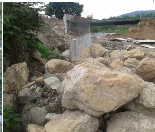
ZONA DE DESCARGAS CLANDESTINAS DE AGUAS RESIDUALES
