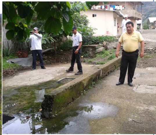
PRIMER CENTRO POBLADO CON PROBLEMAS DE DESCARGA DE AGUAS RESIDUALES
