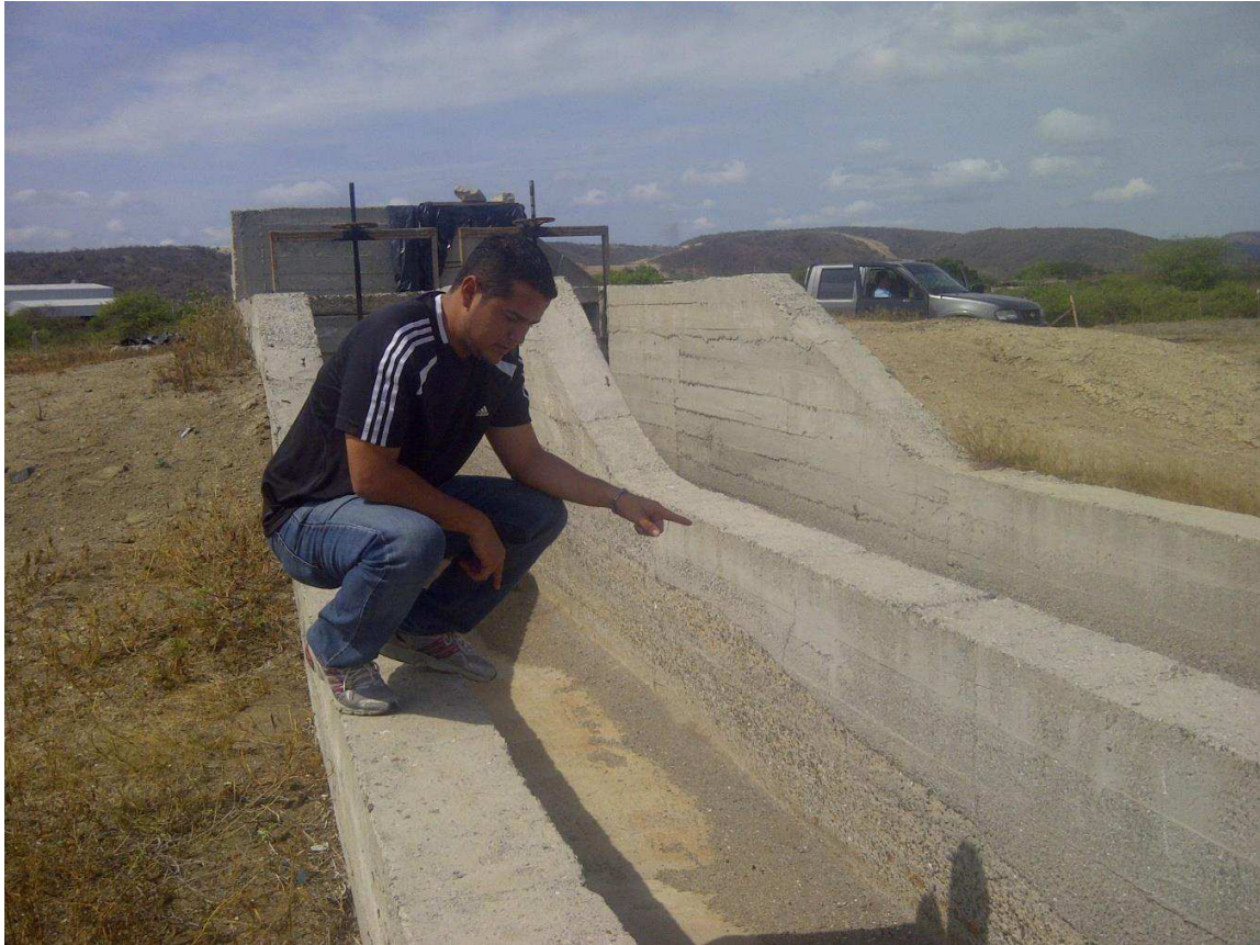
Foto 9. Antiguo sistema de tratamiento de las aguas residuales en la ciudad de Manta.
