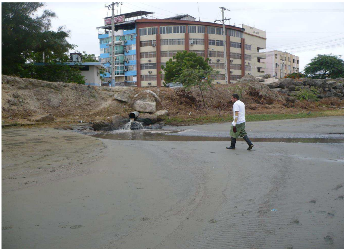
Foto 14. Agua de cárcamos frente al Hotel “Las Rocas” en la desembocadura hacia la playa de Tarqui
