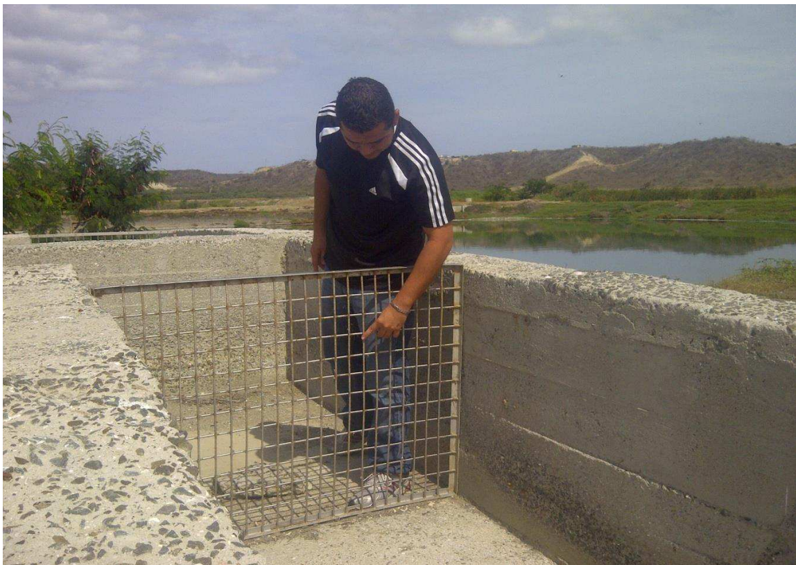
Foto 10. Rejillas para retención de sólidos del antiguo sistema de tratamiento de aguas residuales.
