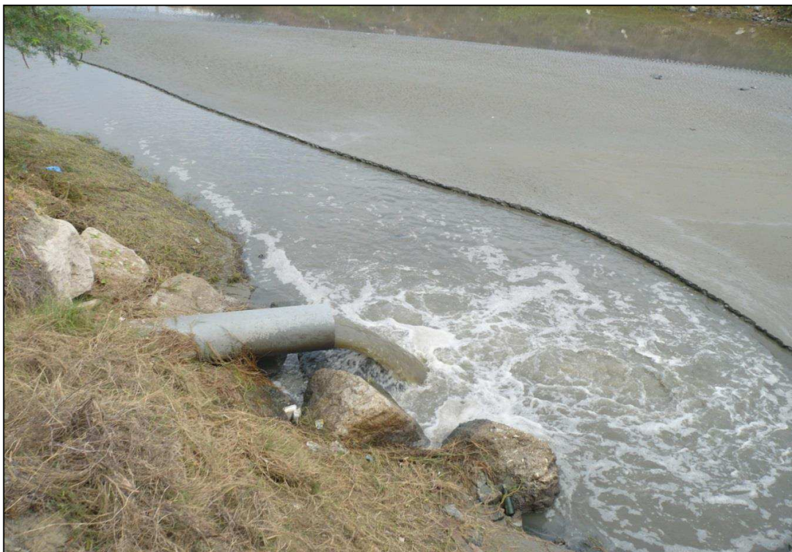
Foto 12. Descarga por rebose de la estación de bombeo de la Epam ubicada diagonal al hotel "Las Rocas"
