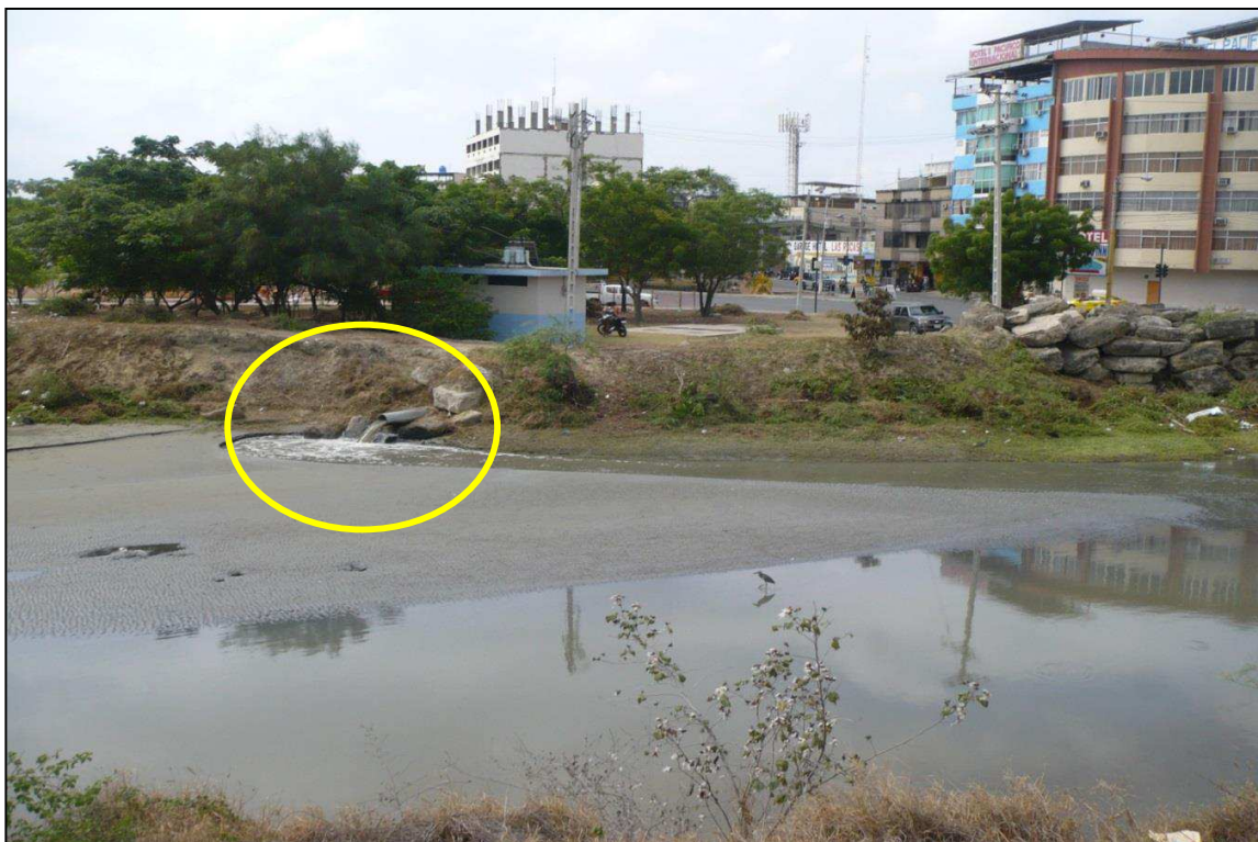
Foto 13. Descarga por rebose de la estación de bombeo de la Epam ubicada diagonal al hotel "Las Rocas"
