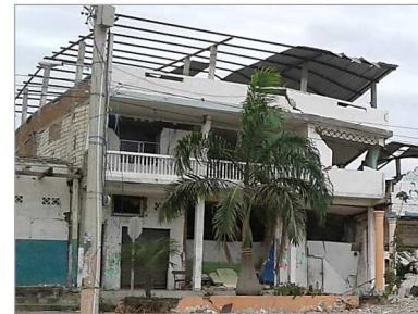
Foto #1: inmueble con fallas debido a la cresta de la onda sísmica.
