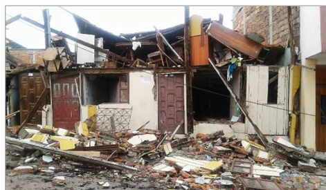
Foto #4: Vivienda con fallas por golpeteo Fuente: Investigación Elaborado por: Investigadora
