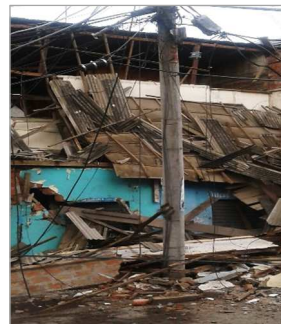
Foto #5: Vivienda con falla de empuje en fachada Fuente: Investigación Elaborado por: Investigadora
