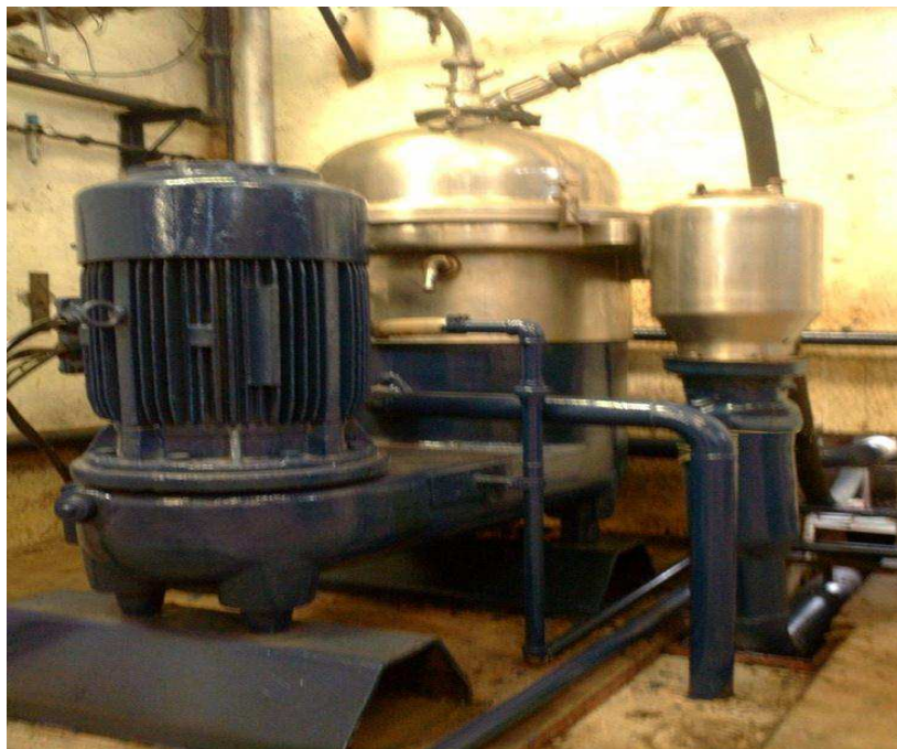
Centrifugas separa sólidos de los líquidos
