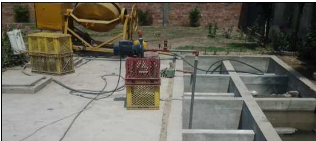
Fig. 6. Aireador de la piscina de aguas residuales
