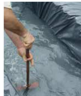
4. Mezclado en el tanque
