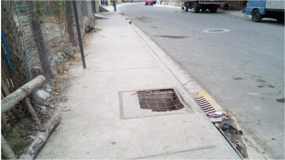
Figura 27 Tapa de Alcantarilla deteriorada en Espacio Público Común Fuente: Elaborada por el Autor
