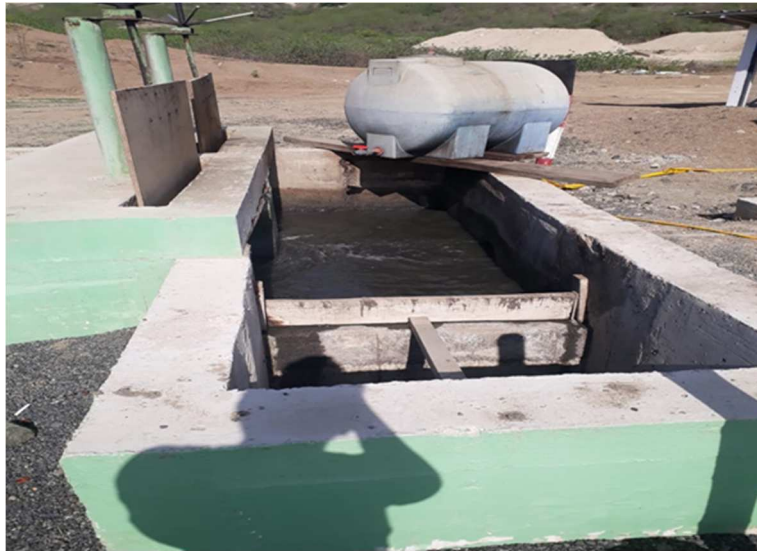
Ilustración 2.3. Afluyente de la planta de tratamiento de aguas residuales de Manta.
