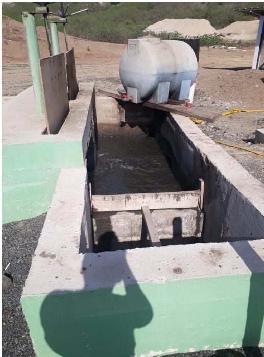
Foto3. Afluente de la Planta de Tratamiento de Agua Residual de Manta.
