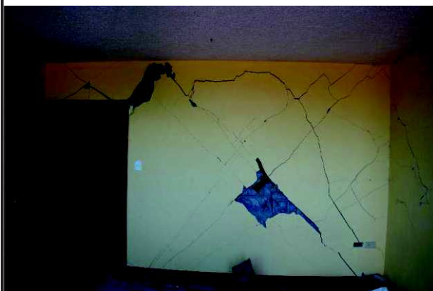
r) Daño grave en mampostería interior en 4PA
