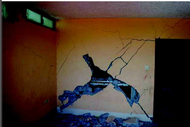
p) Daño grave en mampostería interior en 3PA.
