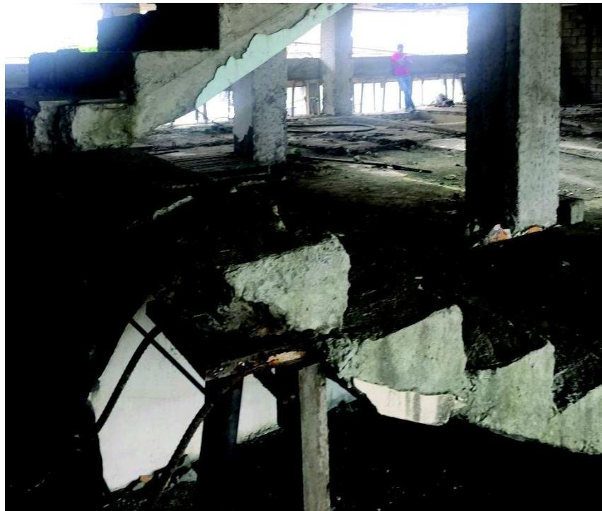
ANEXO 10 DAÑOS GRAVES EN ESCALERAS FUENTE: AUTORES
