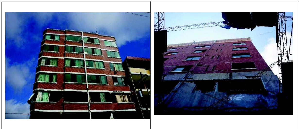
Ilustración II-3 Vista de la fachada principal y Vista de la fachada posterior del edificio VENUS LOOR. Fuente: Autores
