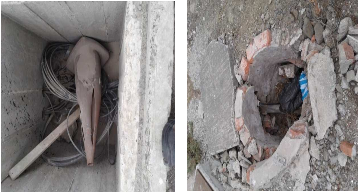
Figura 25. Tramo soterrado desde la acometida hasta la subestación principal. Fuente: el autor.
