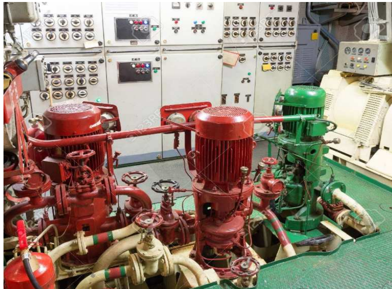
Figura 17. Grupo de bombeo 2×10 hp y 1×5hp. Fuente: Sistemas contra incendios para buque.
