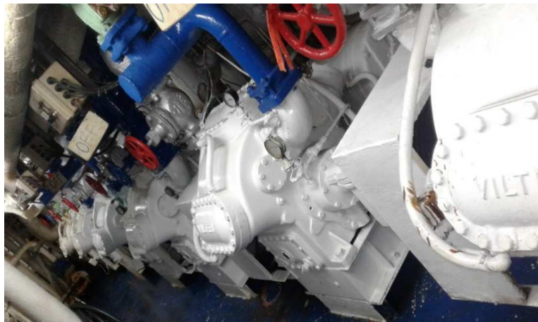
Figura 15. Compresores 6x50hp. Fuente: buque pesquero "JOCAY".
