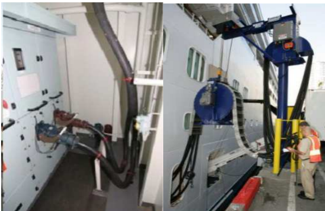
Anexo 2. Conexión eléctrica desde el puerto hacia los buques.
