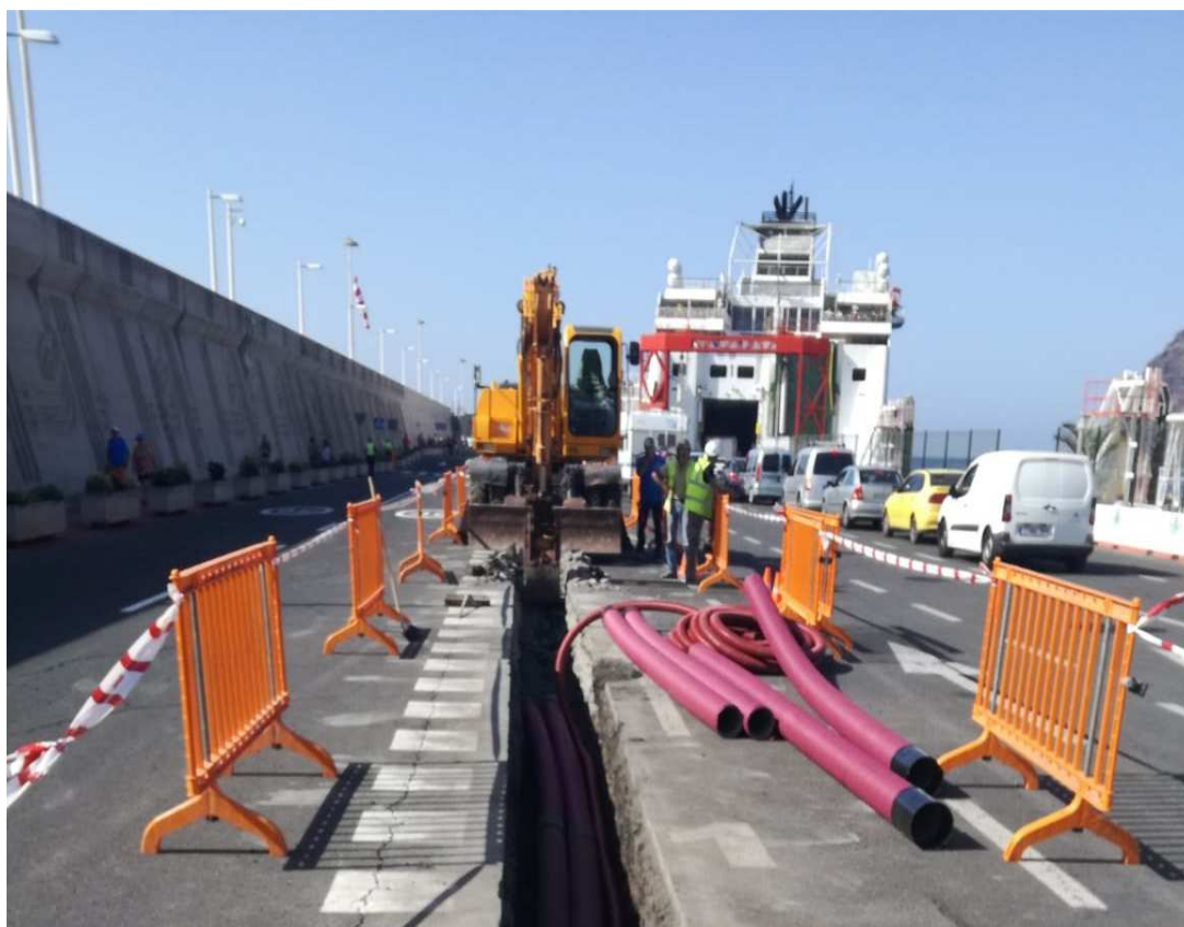
Anexo 4. Soterramiento de los ductos (en los muelles) para la conexión hacia el buque.
