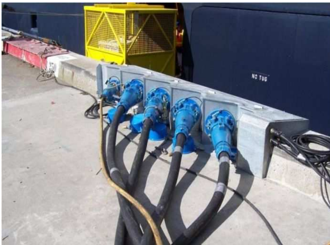
Anexo 3. Tomas de poder antes de su conexión al buque.
