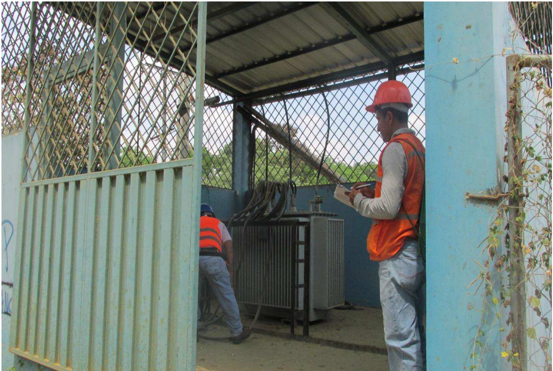
Investigadores Julio Bravo y Edison Cevallos visitando el Transformador de 1000KVA
