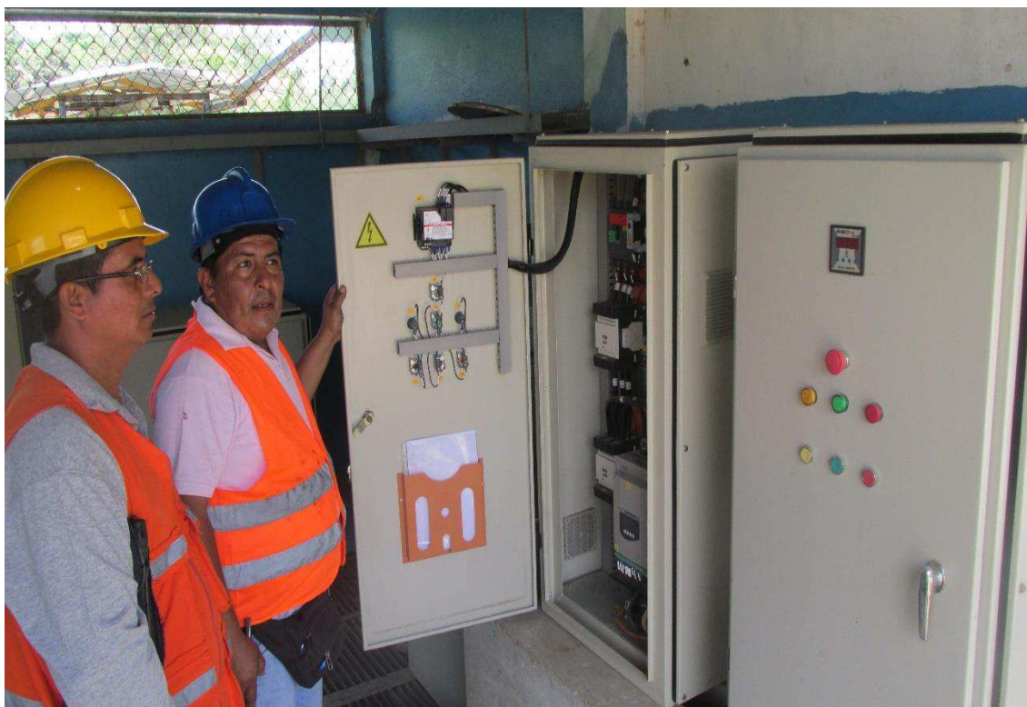
Investigador Julio Bravo revisando el tablero de transferencias de la Planta de Agua Potable La Estancilla
