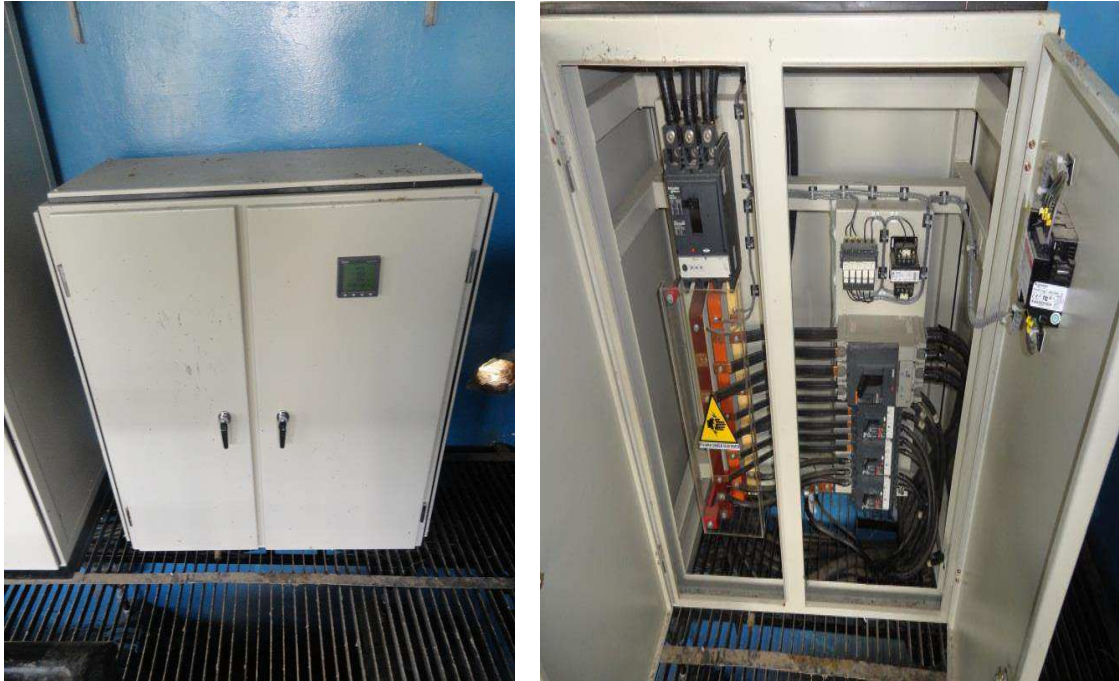
Figura N° 3.11: Tablero de fuerza del transformador T09e
