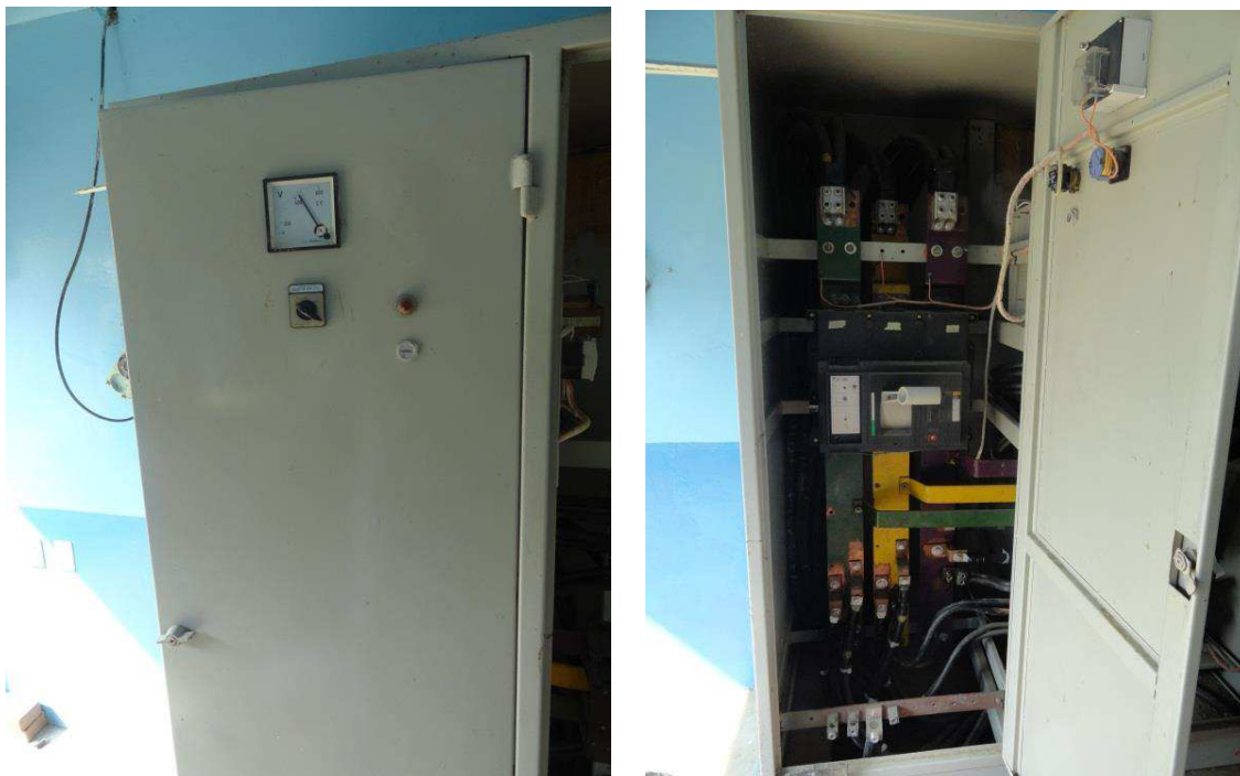
Figura N° 3.6: Tablero de transferencia transformador T01e
