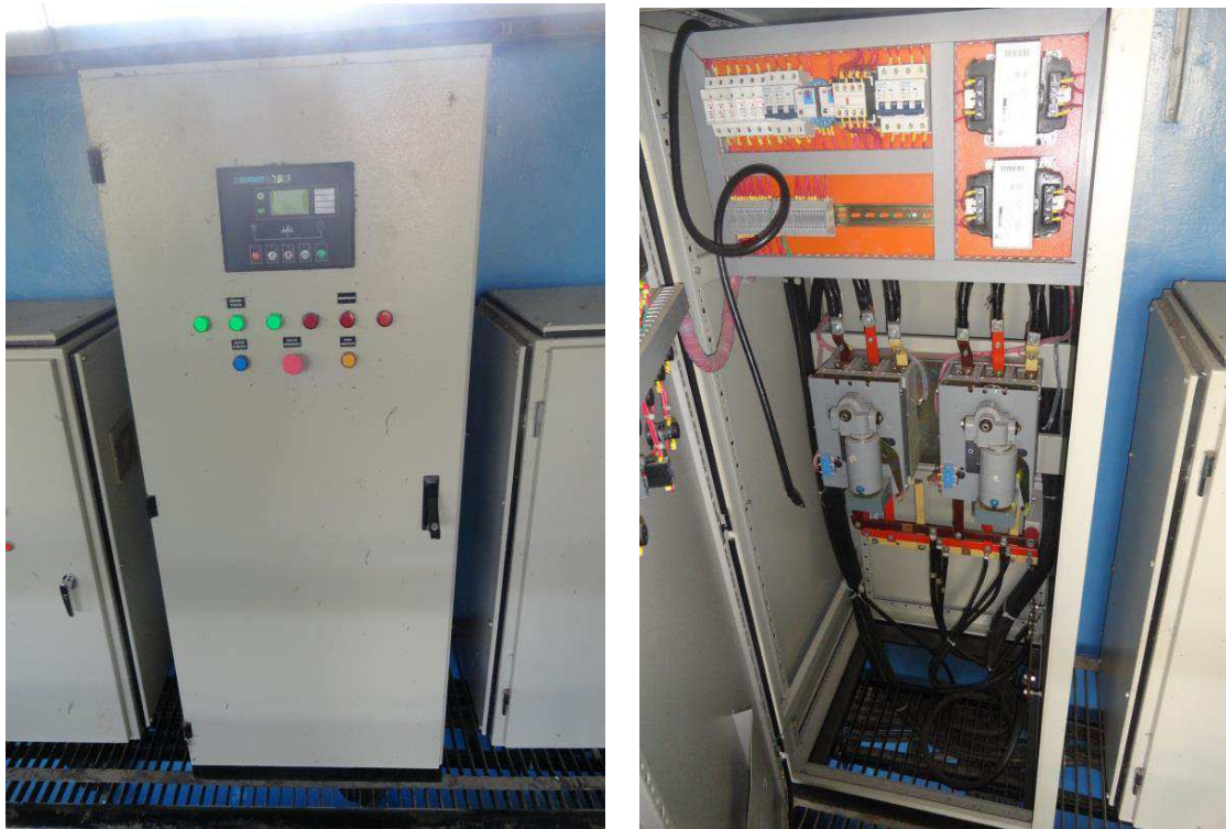
Figura N° 3.10: Tablero de transferencia transformador T09e
