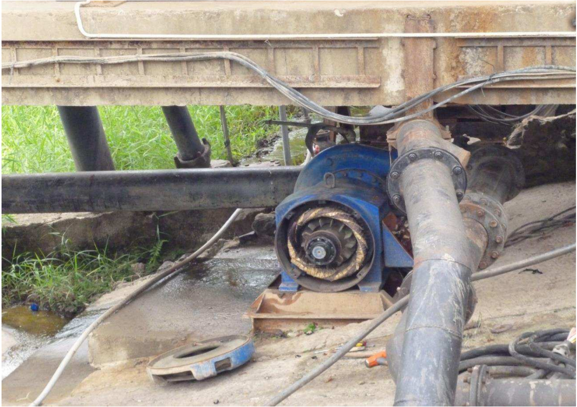
Bomba de agua cruda 90 HP
