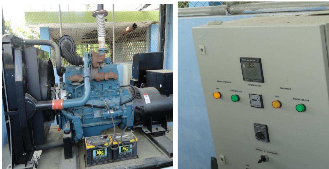
Figura N° 3.4: Equipo electrógeno; tablero de transferencia automático
