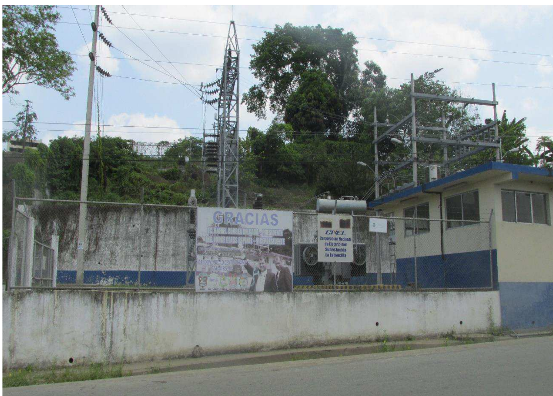
Subestación de la Planta de Agua Potable La Estancilla
