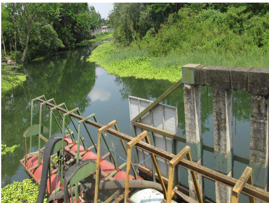
Captación de agua cruda
