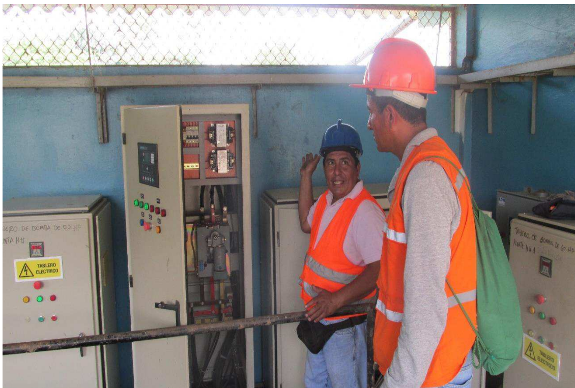
Investigador Edison Cevallos preguntando y obteniendo repuestas de tablero de mando
