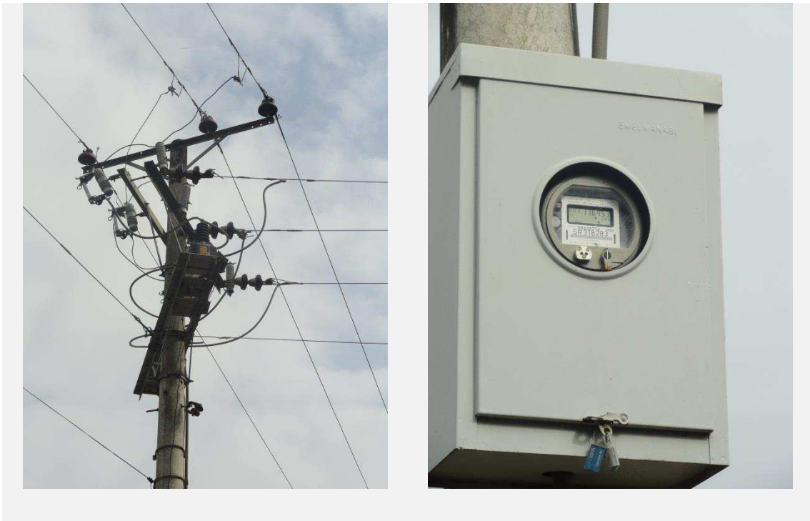
Figura N° 3.2: Estructura de media tensión t tablero de medición comercial
