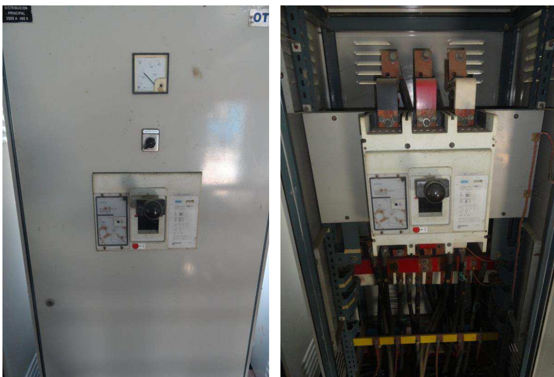
Figura N° 3.7: Tablero de control del transformador T02e
