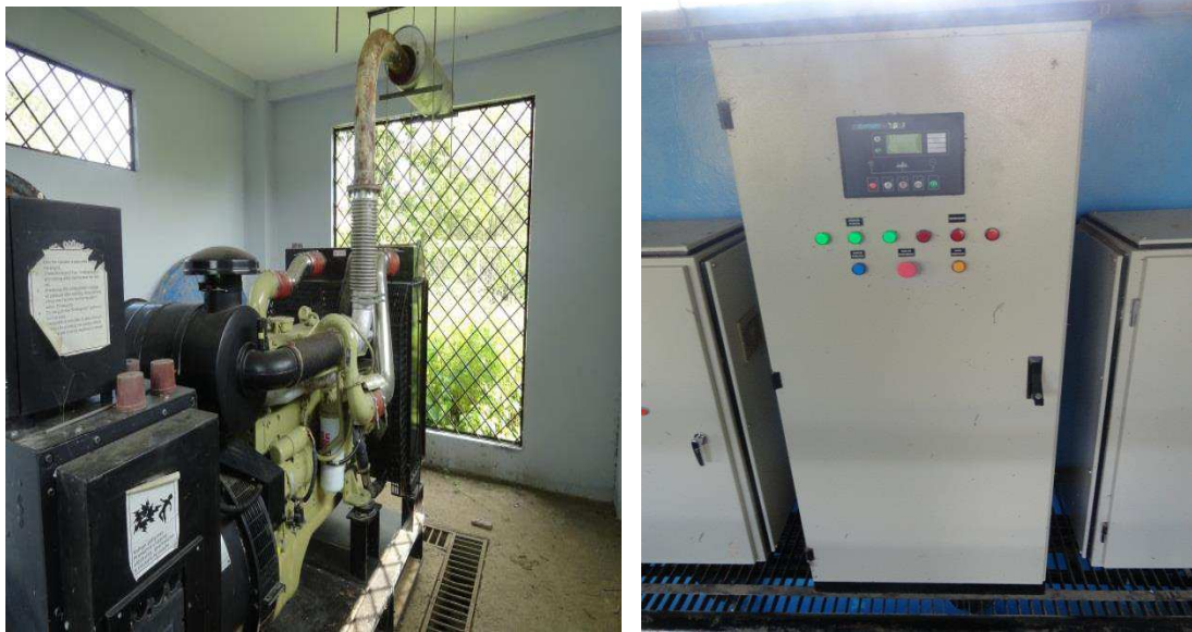
Figura N° 3.5: Primotor y generador G02, tablero de transferencia automático
