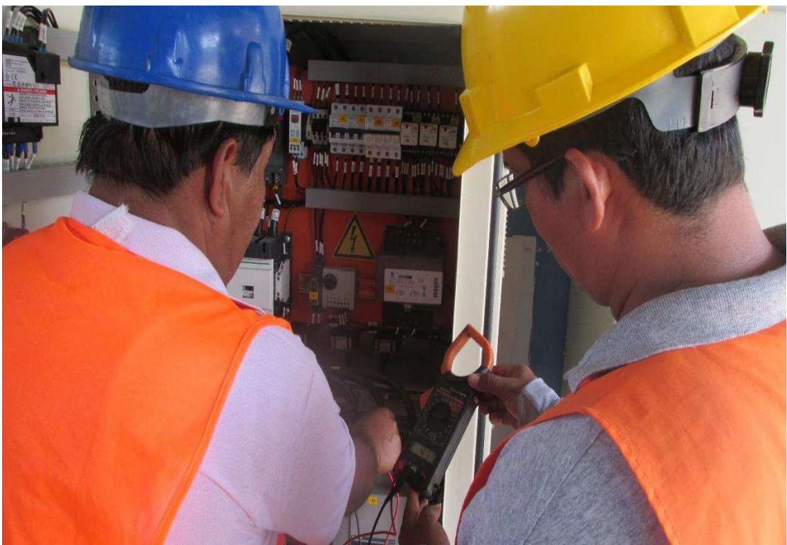
Investigadores Julio Bravo y Edison Cevallos verificando medida de voltaje y corriente en el tablero de control
