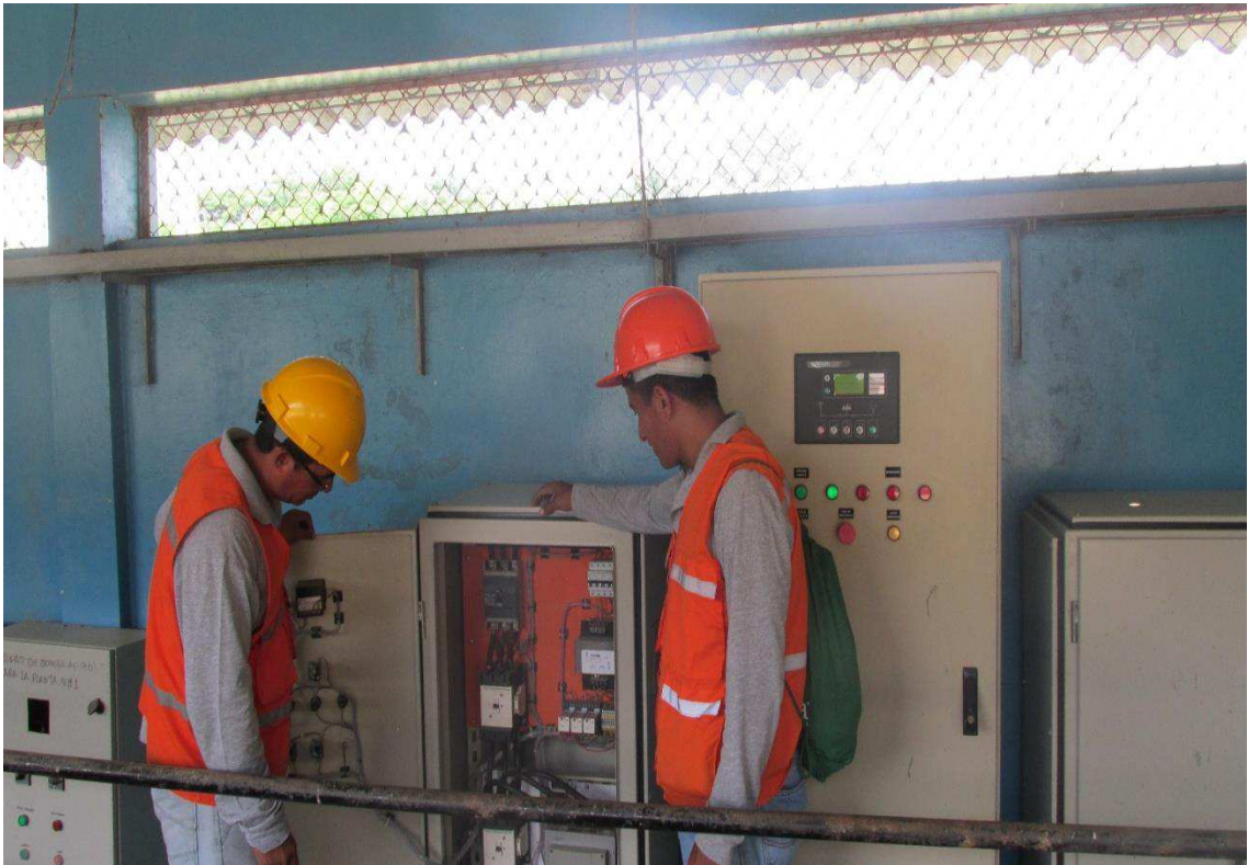
Investigadores Julio Bravo y Edison Cevallos revisando tableros de mando y verificando medida de voltaje y corriente
