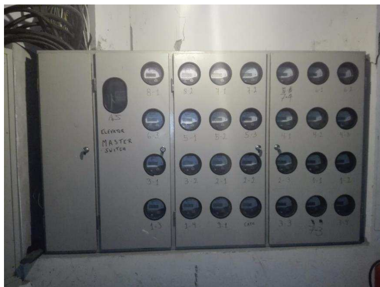
Figura 3.6: Tablero de medidores CNELEP
