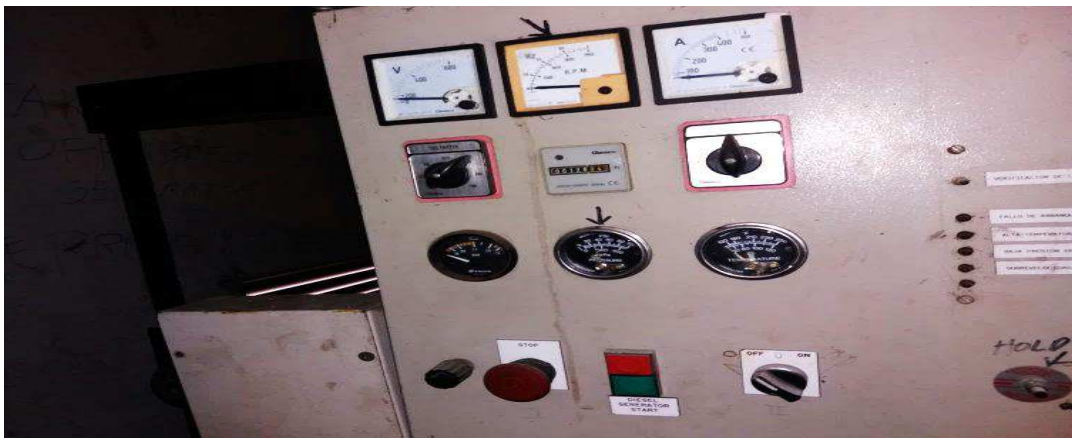
Figura 3.4: Tablero de transferencia y medición
