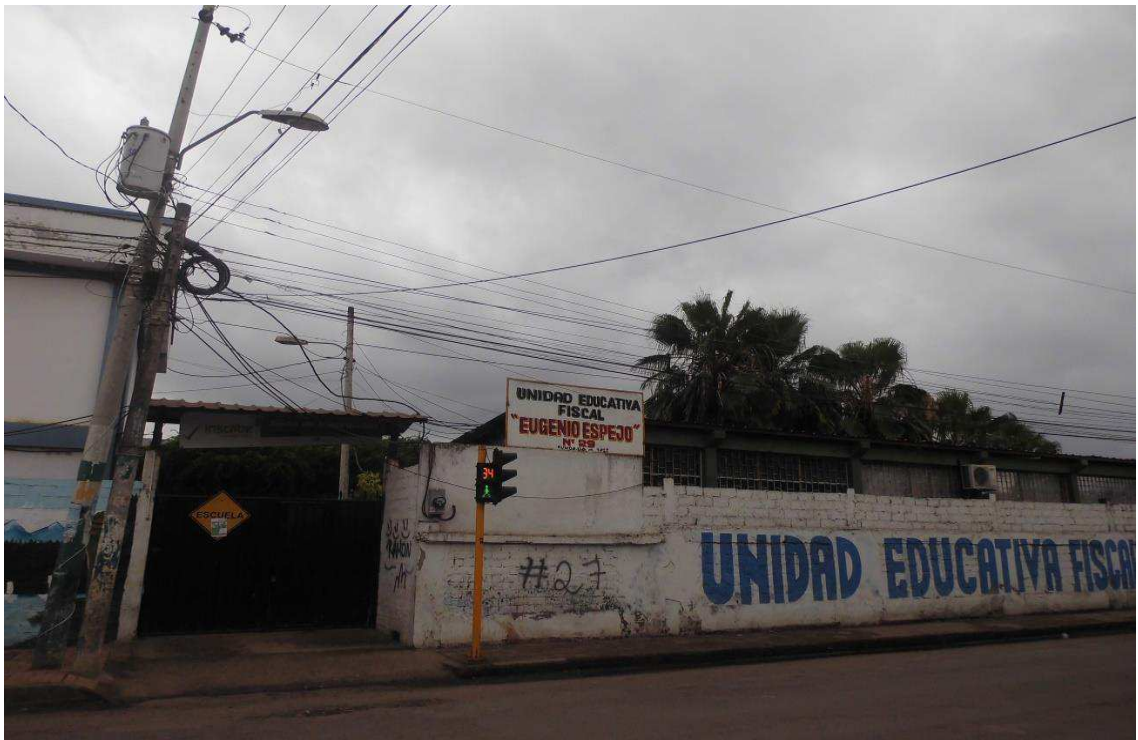
Centro de carga (transformador) de la Unidad Educativa Fiscal Eugenio Espejo # 29
